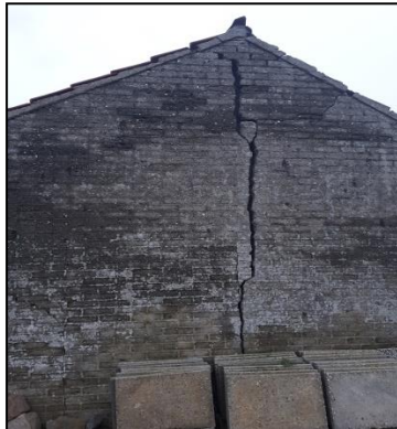
Figuur 10. Schuur met scheur ten noorden van de onderzoekslocatie.
