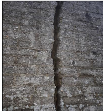
Figuur 11. Zichtbare spouw in de muur.
