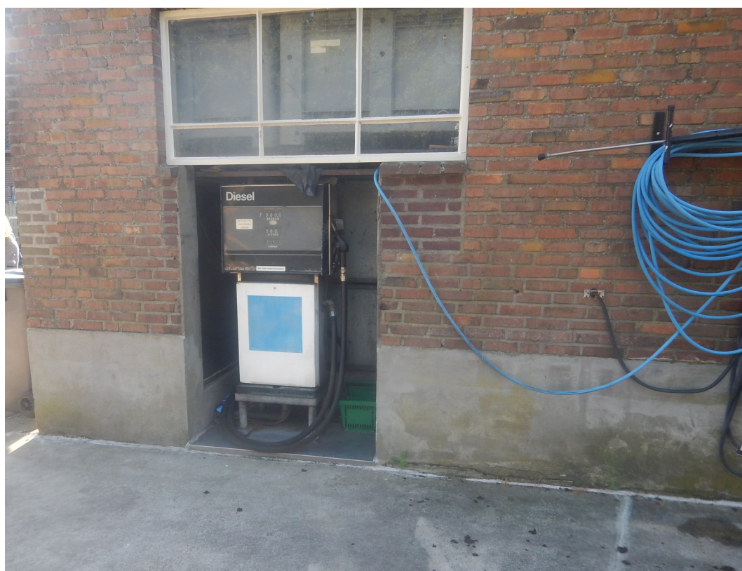
Figuur 43: Dieselpomp ter hoogte van boorprofiel 7. Foto genomen tijdens veldwerk.
