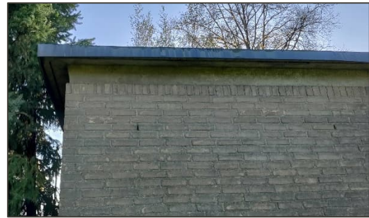
Afbeelding 22. Open stootvoegen in elektriciteitshuisje Nobisweg.
