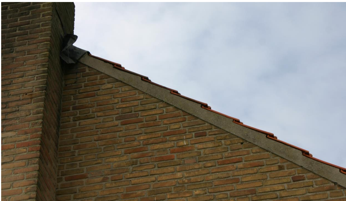
Figuur 4.5.2. De gevelpannen zijn in cement gelegd. Hierdoor is er geen ruimte voor gierzwaluwnesten.
