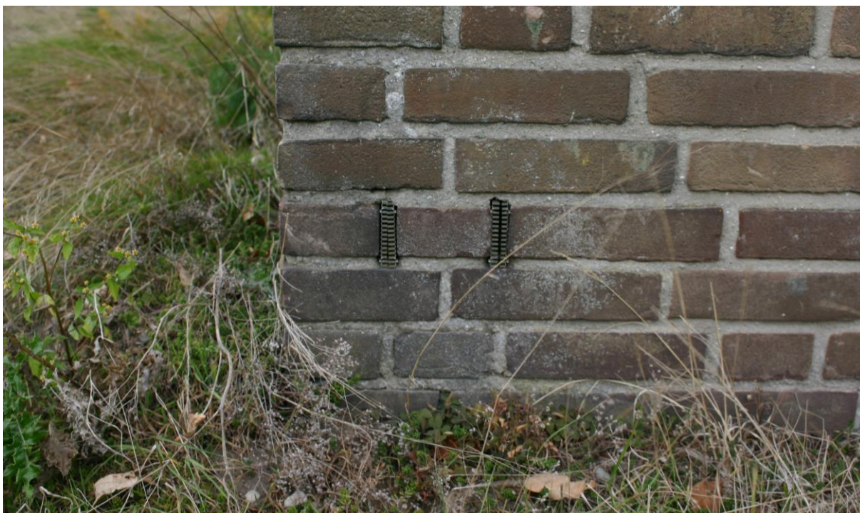
Figuur 4.5.3. Het woonhuis heeft enkele open stootvoegen op enkelhoogte. Deze zijn dichtgemaakt met gaas en daardoor niet toegankelijk voor vleermuizen.
