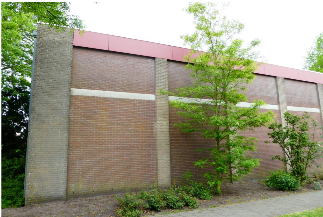
Figuur 3.1: Open stootvoegen in de spouwmuren van de te slopen sporthal.
