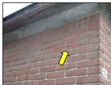
Figuur 17. Stootvoeg in de muur van het trafohuisje.
