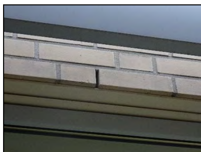
Figuur 15. Stootvoeg in de muur van het gezondheidscentrum.
