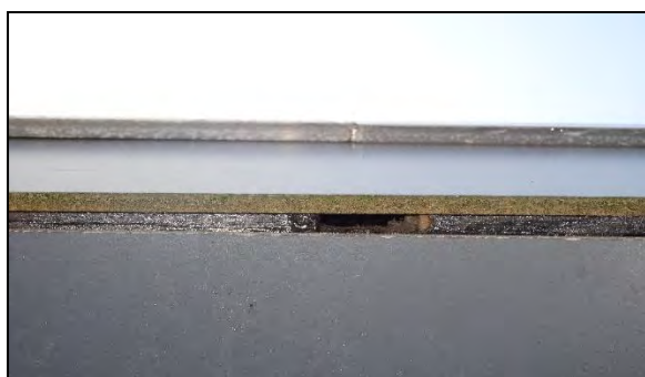
Figuur 13. Gleuf in de boeidelen van het bedrijfsgebouw.
