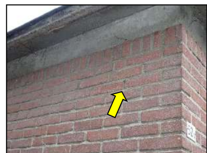
Figuur 17. Stootvoeg in de muur van het trafohuisje.
