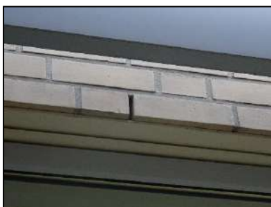
Figuur 15. Stootvoeg in de muur van het gezondheidscentrum.
