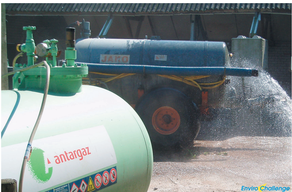
Illustratie 4 : Opslag van propaan in bovengrondse tank
