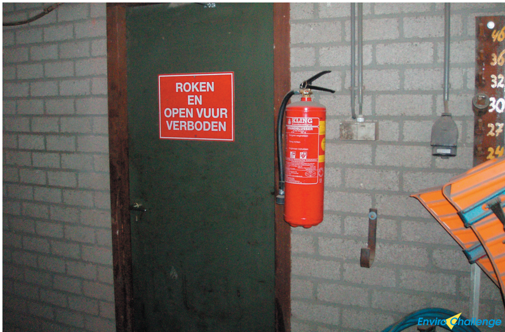
Illustratie 3 : Verbod op roken en open vuur bij olieopslagplaats
