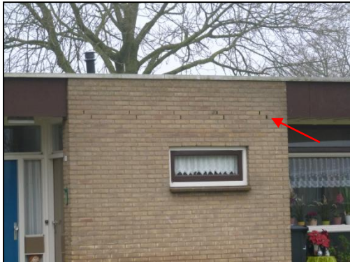
Figuur 9. Open stootvoegen, die toegang geven tot de spouwmuur.
