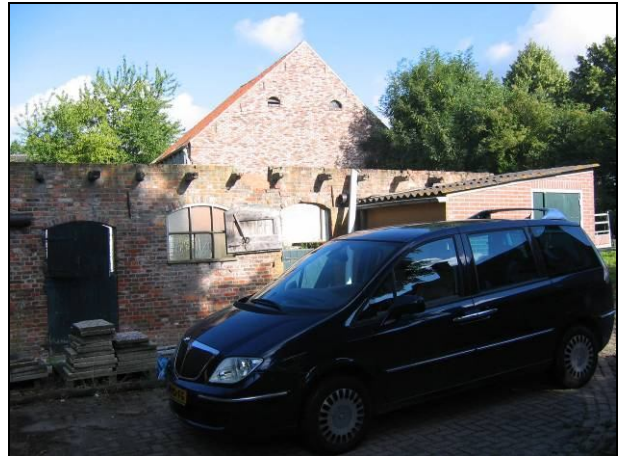
Deels gesloopte agrarische bedrijfsgebouwen
