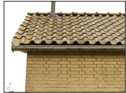
Figuur 8. Schuur ten zuidwesten van de planlocatie. Deze schuur is mogelijk geschikt voor verblijfplaatsen van vleermuizen.
