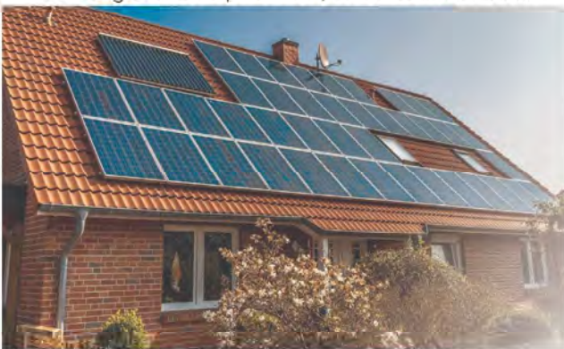
Voorbeeld verkeerd gelegde zonnepanelen
