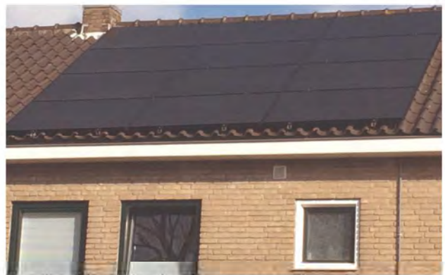
Voorbeeld goed gelegde zonnepanelen
