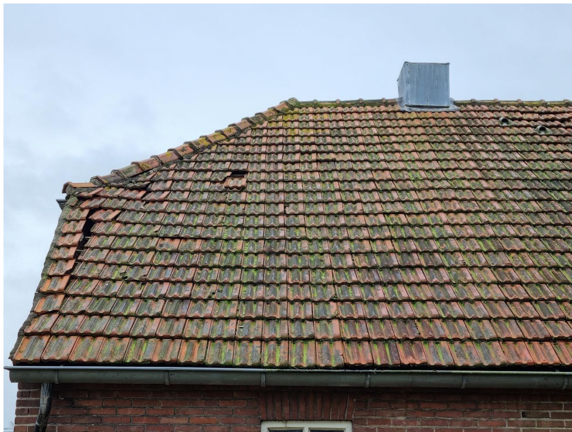
Figuur 14 Ter hoogte van het woongedeelte zijn er losliggende of verschoven dakpannen aanwezig, die toegang kunnen bieden tot geschikte ruimtes voor vleermuisverblijfplaatsen. De achterliggende ruimtes kunnen daarnaast ook geschikt zijn voor nestlocaties van Huismus.
