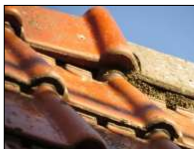
Figuur 7. Niet aansluitende dakpannen
