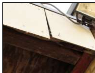
Figuur 8. Kieren achter gevelplaten
