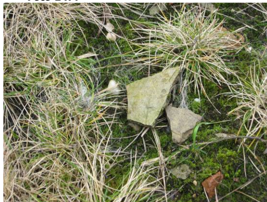
Asbest op maaiveld A3
