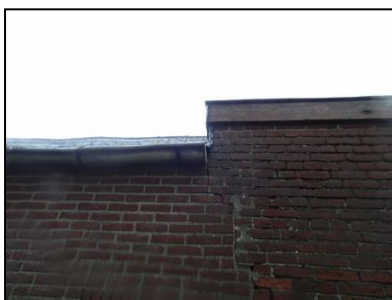
Figuur 14. Detailfoto van het woonhuis/opstal 1. Zichtbaar in de foto is een scheur in de buitenmuur.
