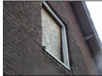
Figuur 17. Kozijn van het woonhuis. Zichtbaar is een kier tussen het kozijn en het houten paneel.
