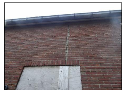
Figuur 16. Detailfoto van de westelijke gevel van het woonhuis. Zichtbaar in de foto is een scheur in de buitenmuur boven het dichtgetimmerde kozijn.
