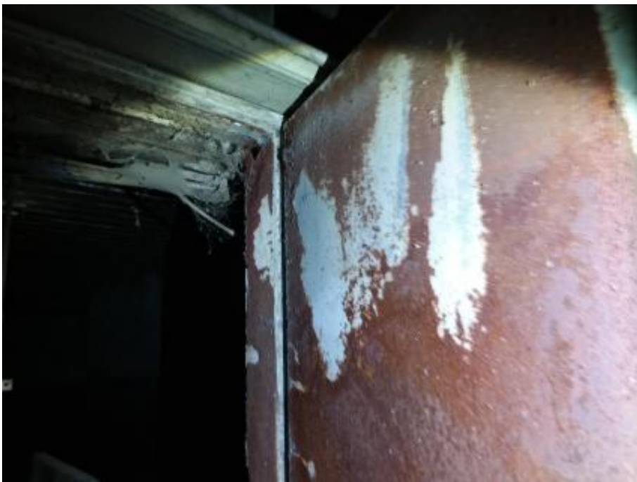
vleesvarkensstal met corridor: metalen deuren
