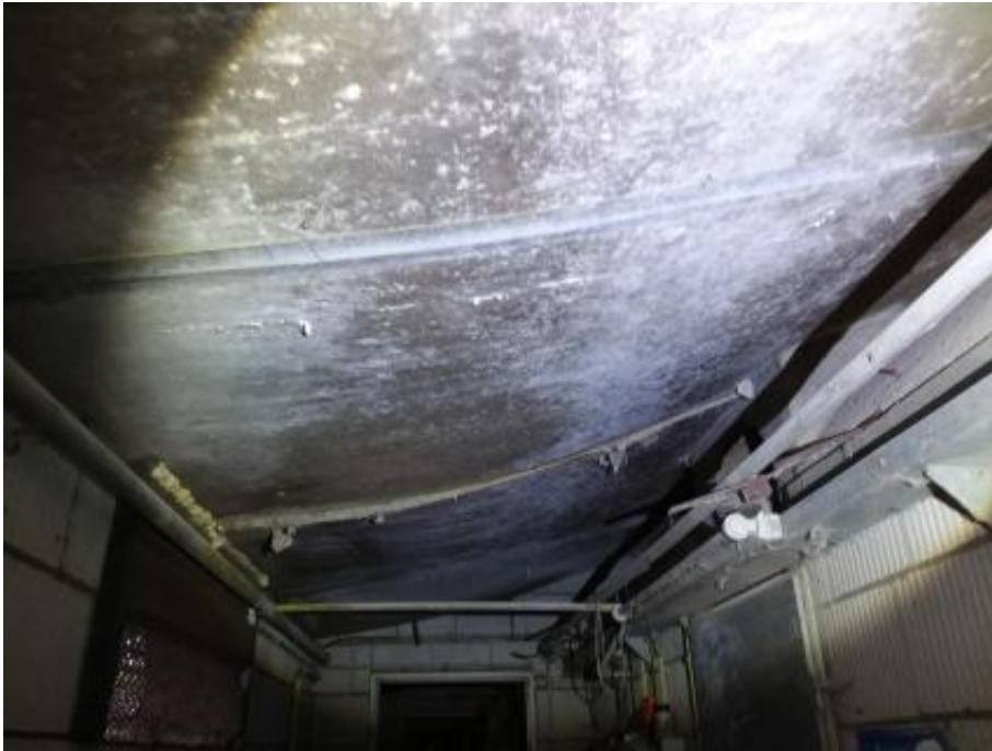
vleesvarkensstal met corridor: Dupanel dakisolatie
