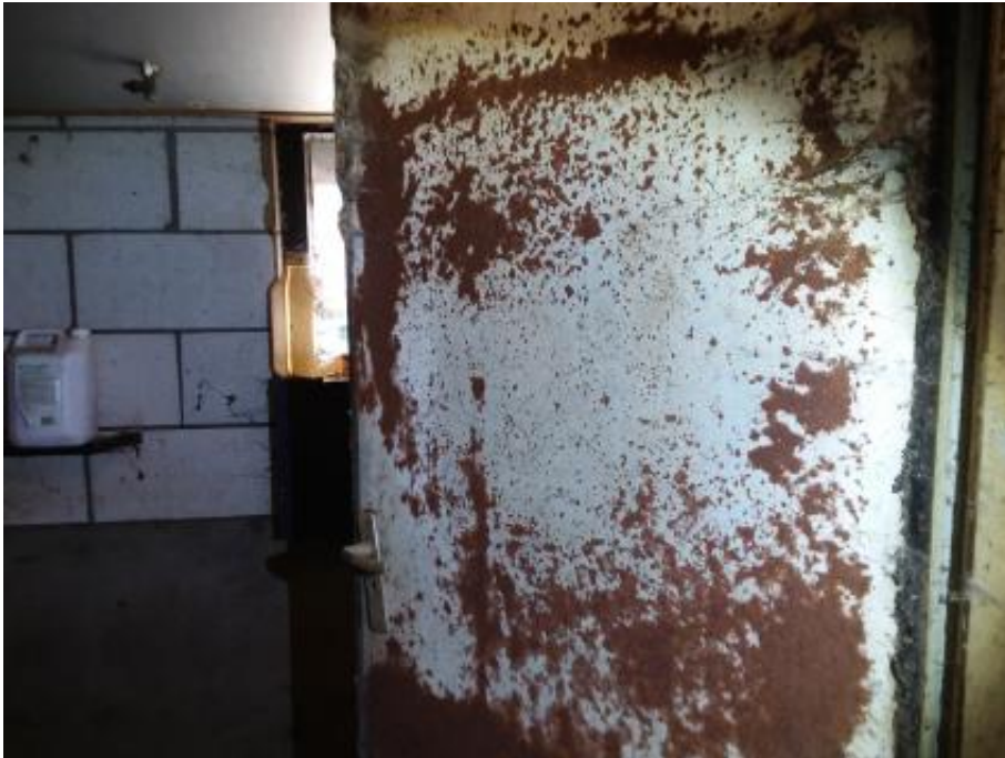
achterste deel zeugenstal en zeugenstal/ vleesvarkensstal metalen deuren
