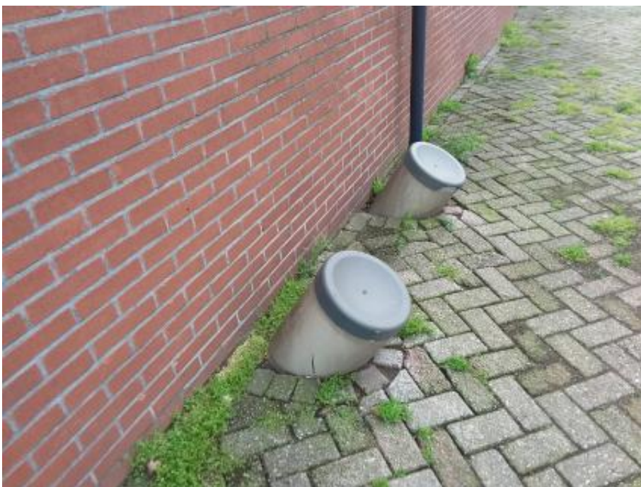
vleesvarkensstal met corridor: kunststof buizen bij zijgevels
