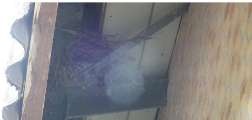
Figuur 2 Een van de houtduivennesten onder de overstek van het dak.
