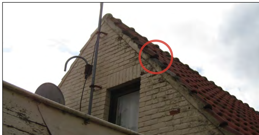
Figuur: tussen sommige dakpannen is ruimte aanwezig, waardoor vleermuizen toegang hebben tot de ruimte tussen de dakpannen en het dakbeschot.
