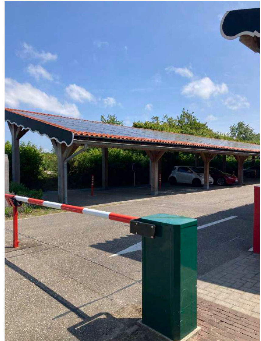
Zonnepanelen bovenop parkeerplekken
