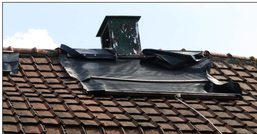
Figuur: het dak is plaatselijk in slechte staat, waardoor er openingen zijn voor bijvoorbeeld vogels. Ook via de schoorsteen kunnen vogels de schuur in.
