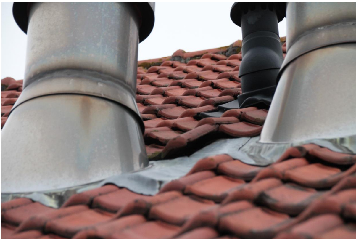
Foto 3. Loszittende pannen (potentieel dagverblijf voor vleermuizen).
