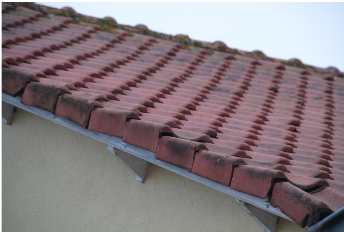
Foto 2. Loszittende pannen (potentieel dagverblijf voor vleermuizen).
