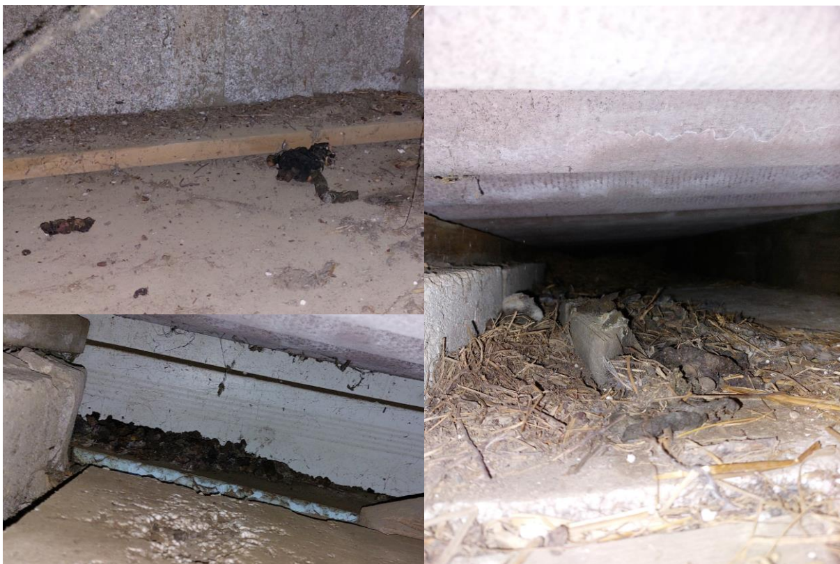
Figuur 4.2.2. Steenmarteruitwerpselen in de stal (linksboven) en op het dakbeschot (rechtsonder en rechts)
