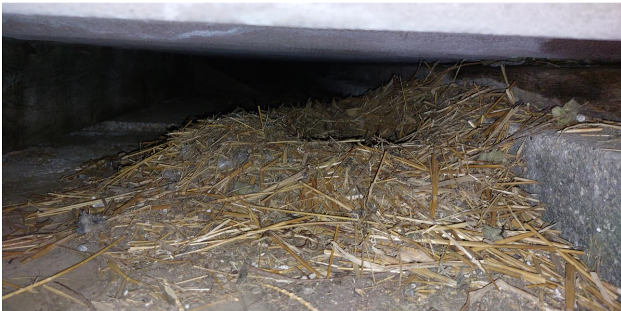
Figuur 4.2.1. Eén van de niet in gebruik zijnde huismusnesten.
