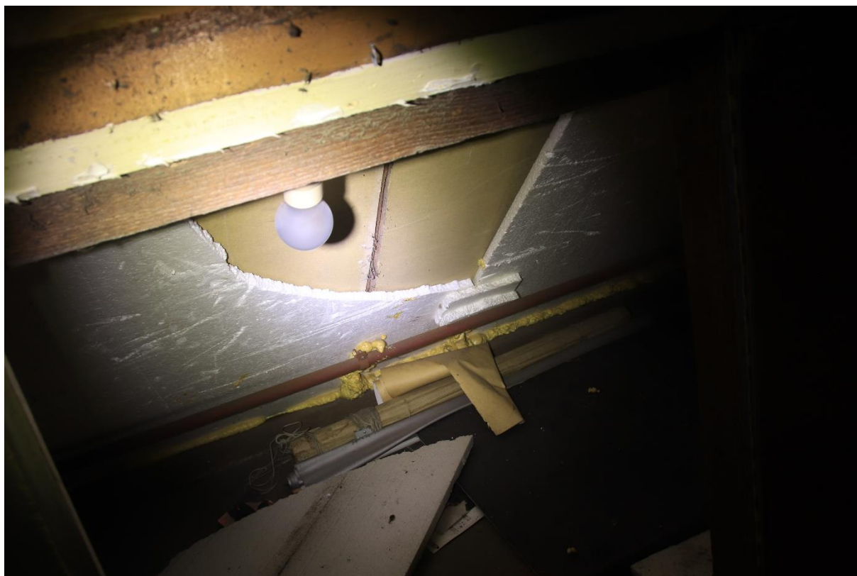
Foto 3: op de meeste zolders zijn asbestplaten aanwezig. Hier in combinatie met piepschuim isolatie plaatjes
