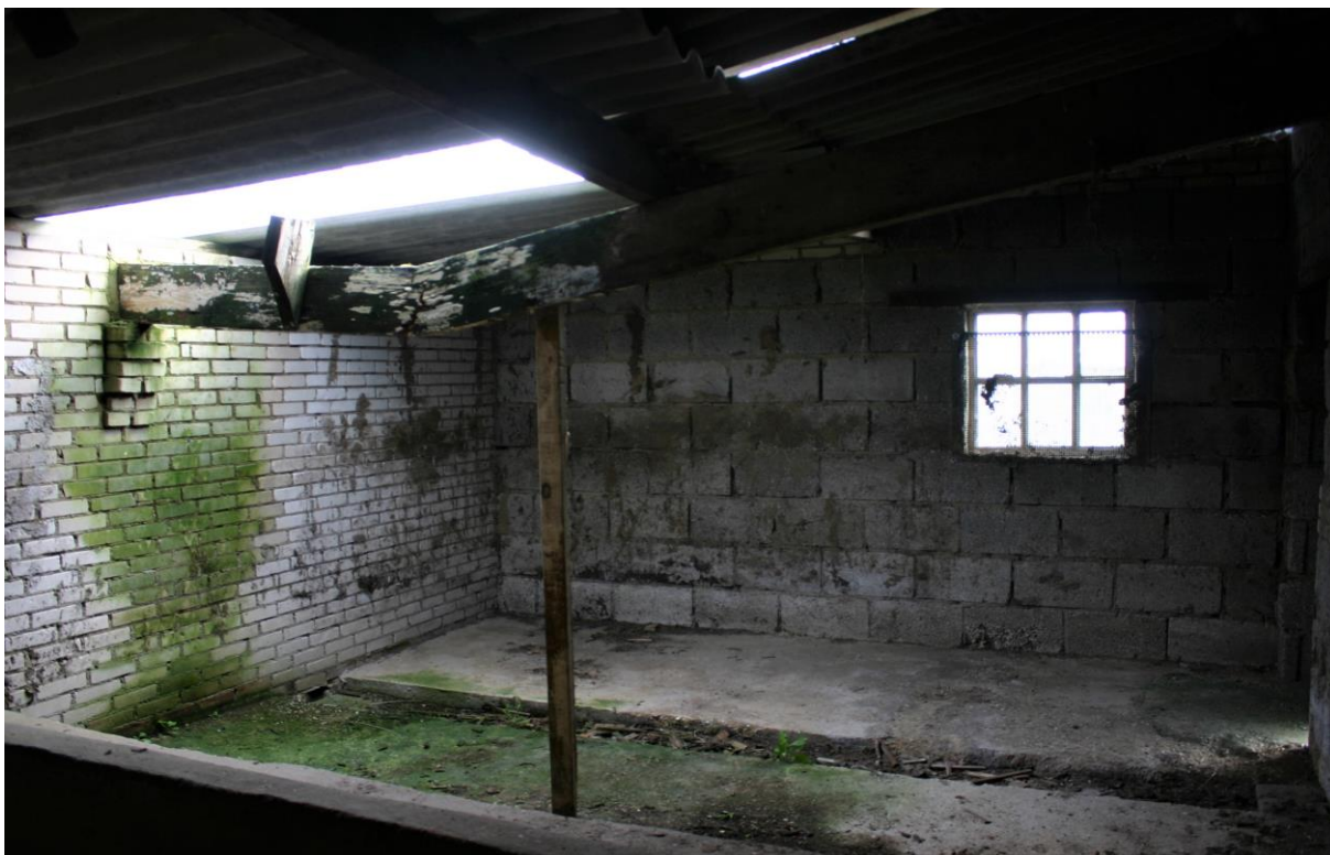
Figuur 4.2.1. Een deel van het dak van stal 1 ontbreekt.
