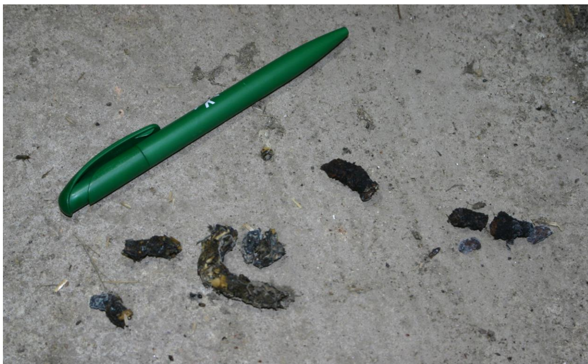
Figuur 4.2.3. Aan de binnenzijde van stal 2 zijn op meerdere plekken steenmarteruitwerpselen aanwezig.
