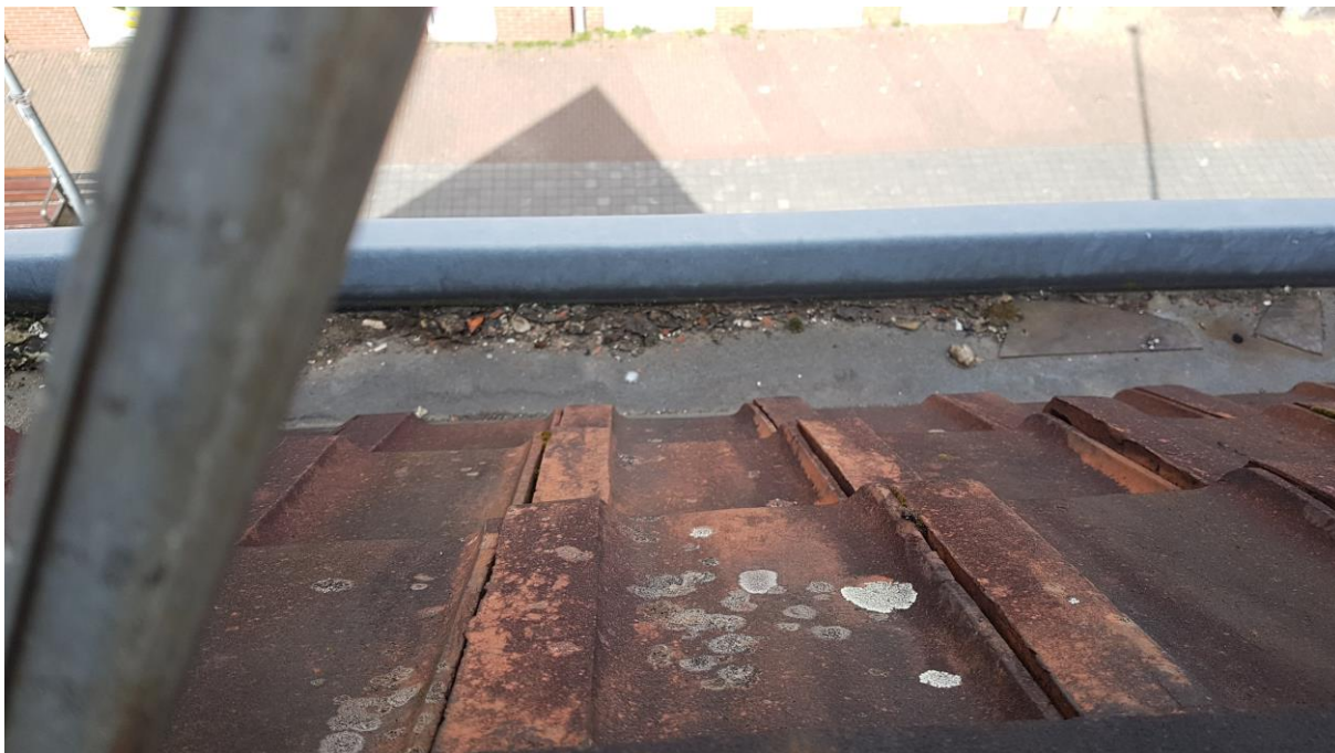
Foto 15: op de dakpannen zijn strepen en krassen te zien waar vaak iets overheen loopt. Vermoedelijk steenmarter.
