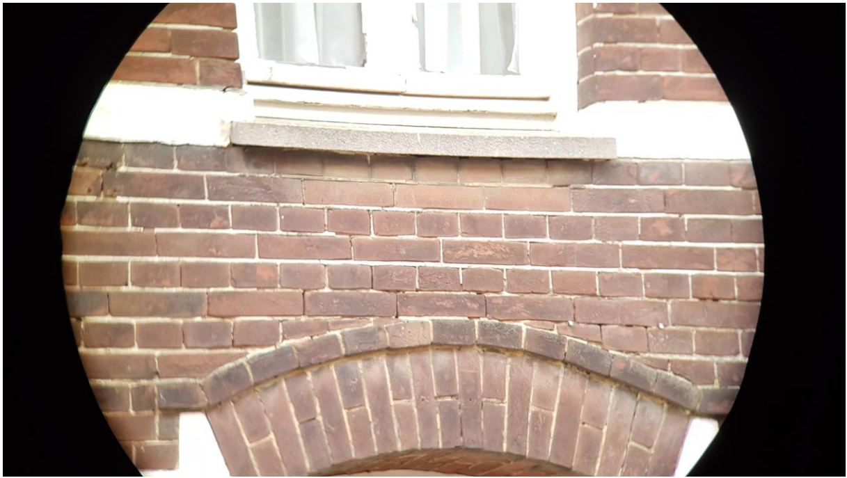
Foto 24: onder de raam dorpels zitten spleten die door vleermuizen gebruikt kunnen worden om de spouw te bereiken.
