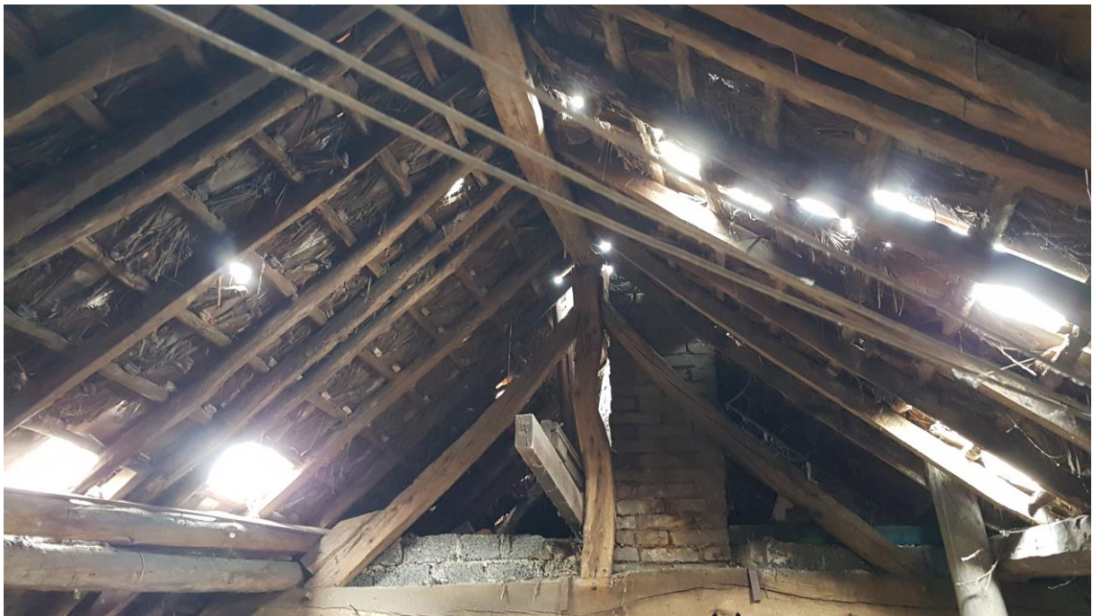
Foto 25: het dak van de schuur heeft veel gaten en lekkages.
