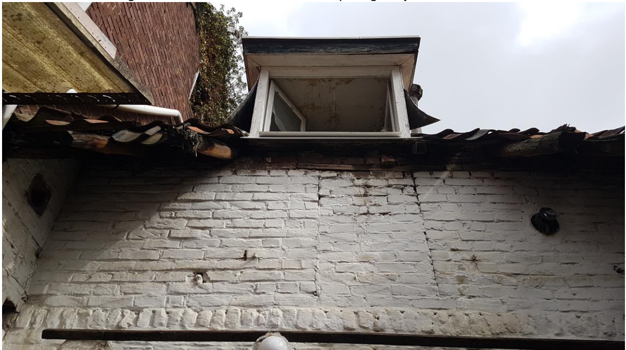
foto 20: door tijden slecht onderhoud is het dak deels ingestort. Hierdoor zijn er vele openingen voor vleermuizen en andere soorten om hierin weg te kruipen.
