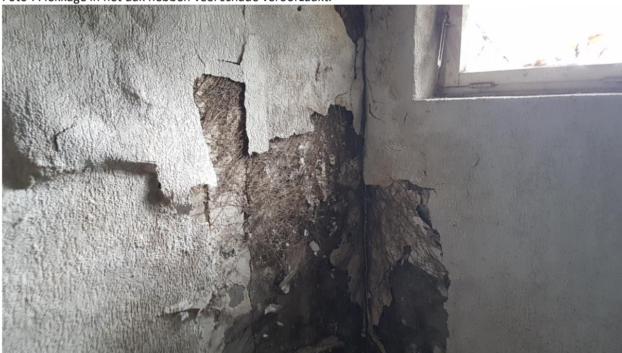
Foto 8: planten wortels die door de zuidelijke muren van het woonhuis heen groeien.
