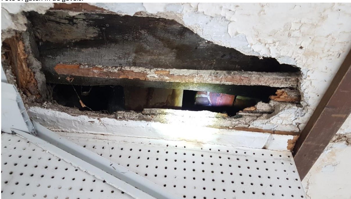
Foto 10: openingen in de plafond platen. De ruimte is verbonden met tussengelegen holtes en de buitenmuren.
