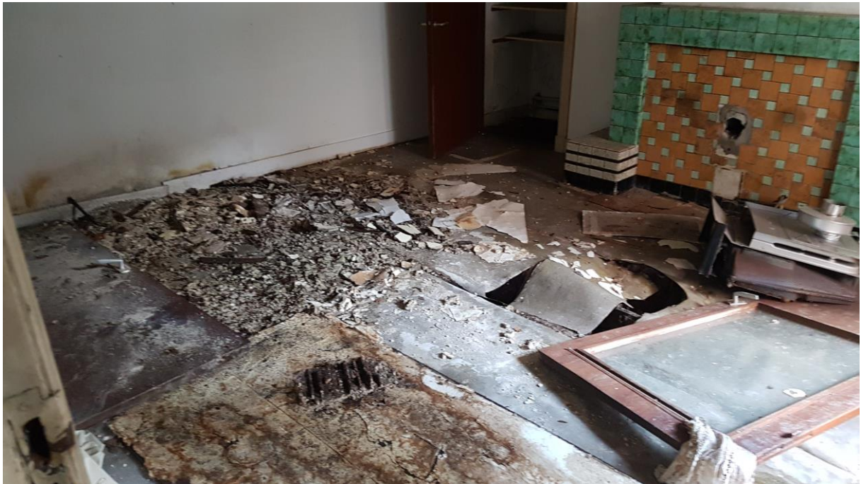
Foto 5: de vloer van het zuidelijke deel van het woonhuis is weggerot.
