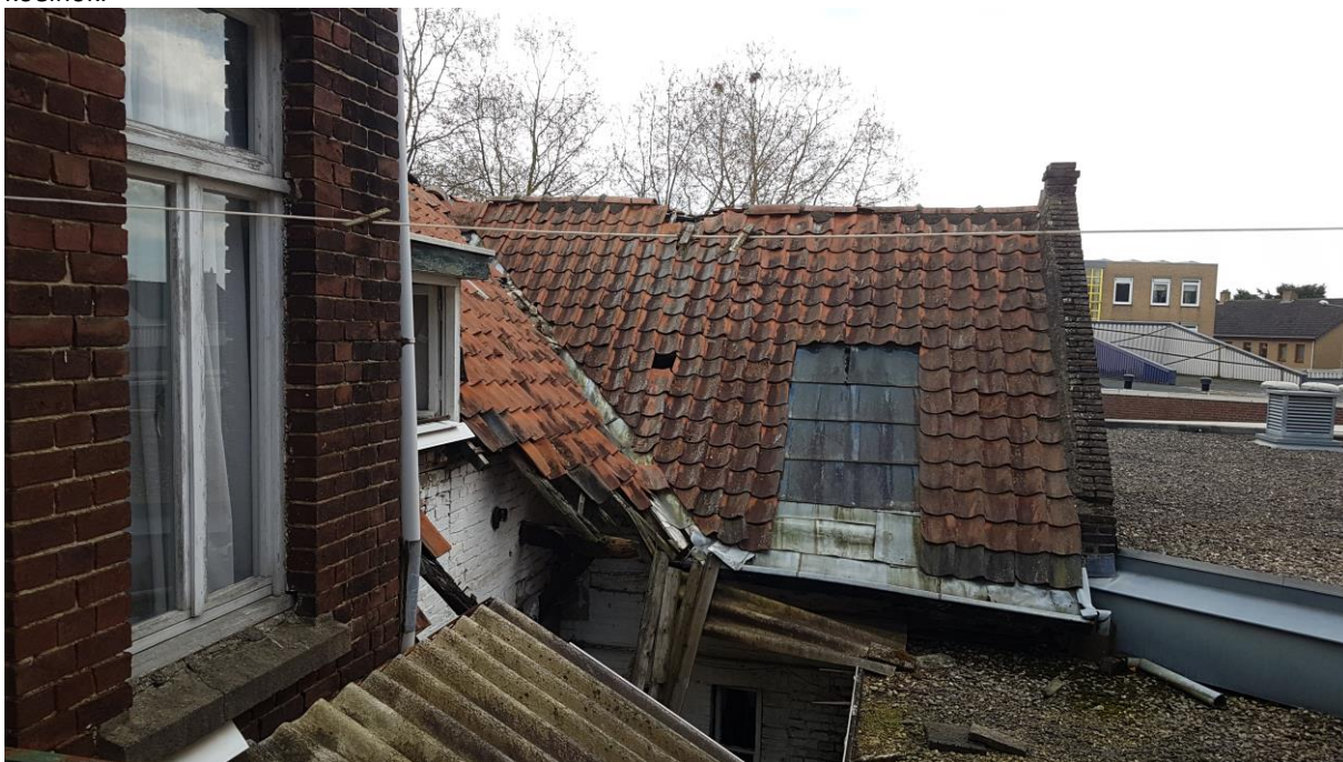
Foto 4: het dak van het woonhuis (deels links) en van de schuur (rechts) zijn in een zeer slechte staat.
