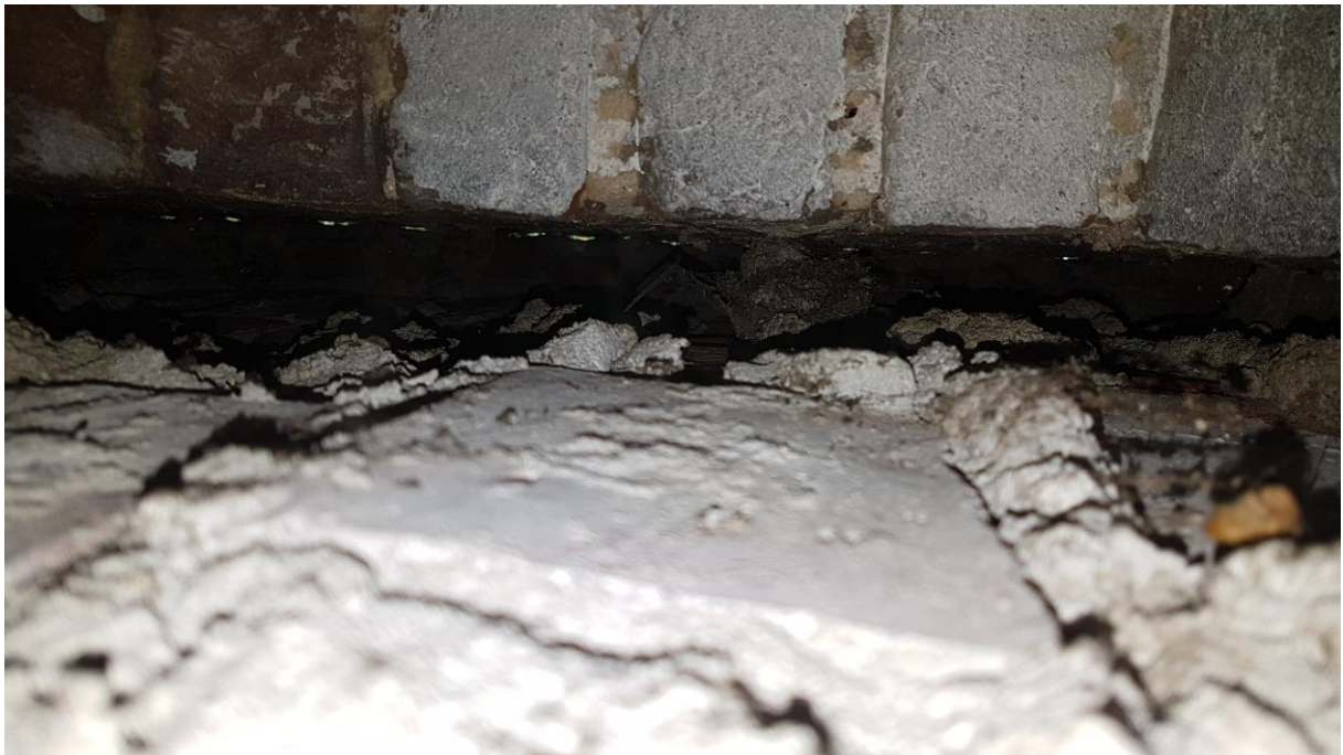
Foto 18: onder is de buitenmuur van het noordelijke buurpand. Boven de buiten muur van de onderzoekslocatie. Er tussen is een holte met gezien de licht punten openingen hiernaartoe.
