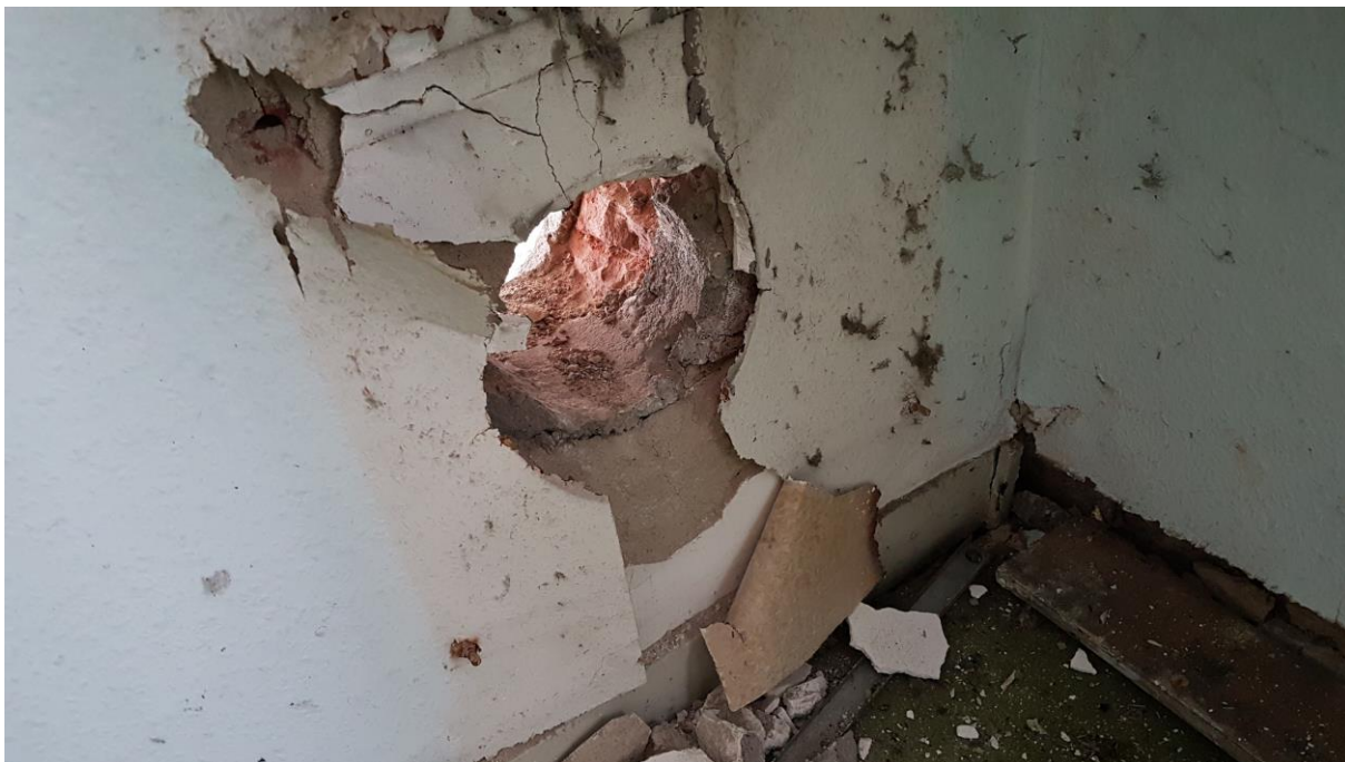
Foto 9: gaten in de gevels.
