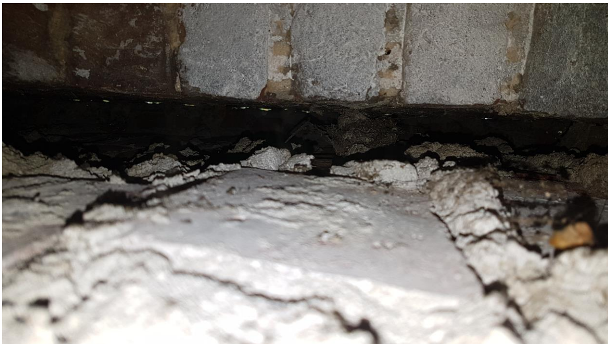
Foto 18: onder is de buitenmuur van het noordelijke buurpand. Boven de buiten muur van de onderzoekslocatie. Er tussen is een holte met gezien de licht punten openingen hiernaartoe.
