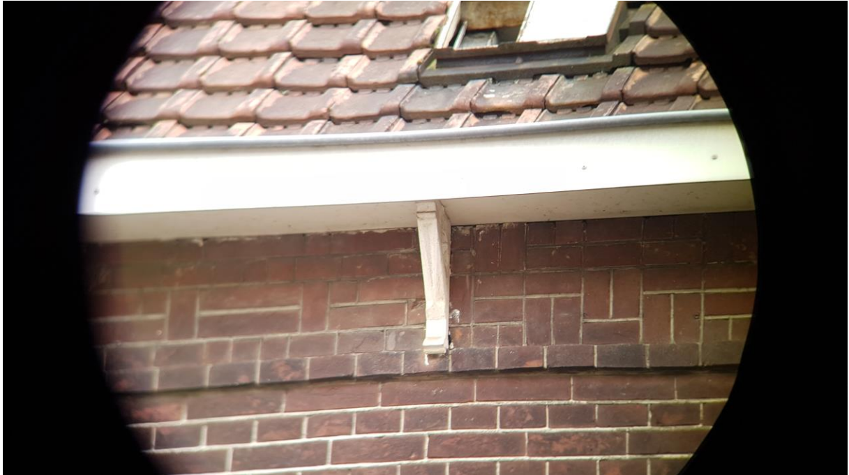
Foto 22: gaten onder de dakrand bij de goot betimmering. Boven het dakraam zonder ruit.
