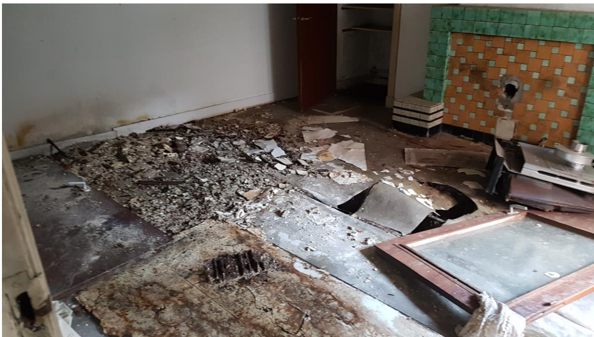
Foto 5: de vloer van het zuidelijke deel van het woonhuis is weggerot.
