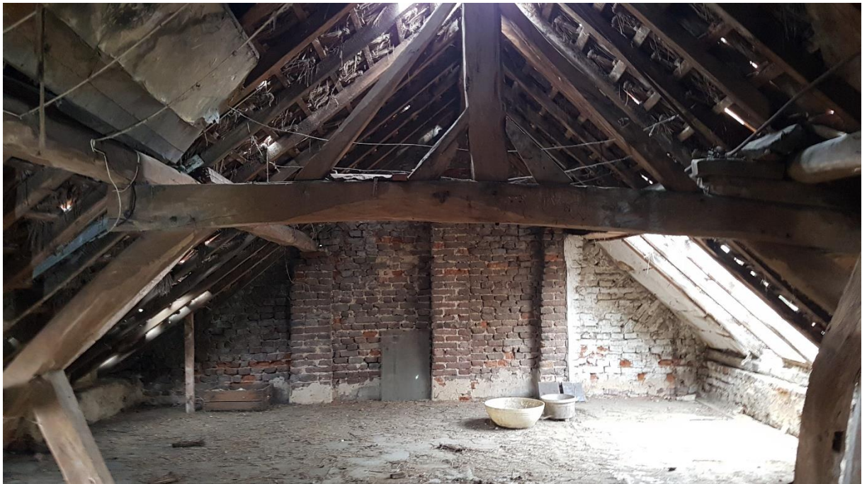
Foto 26: de zolder van de schuur. Her en der ontbreken er dakpannen en zitten er gaten in de vloer. Mogelijk geschikt als foerageergebied voor vleermuizen.
