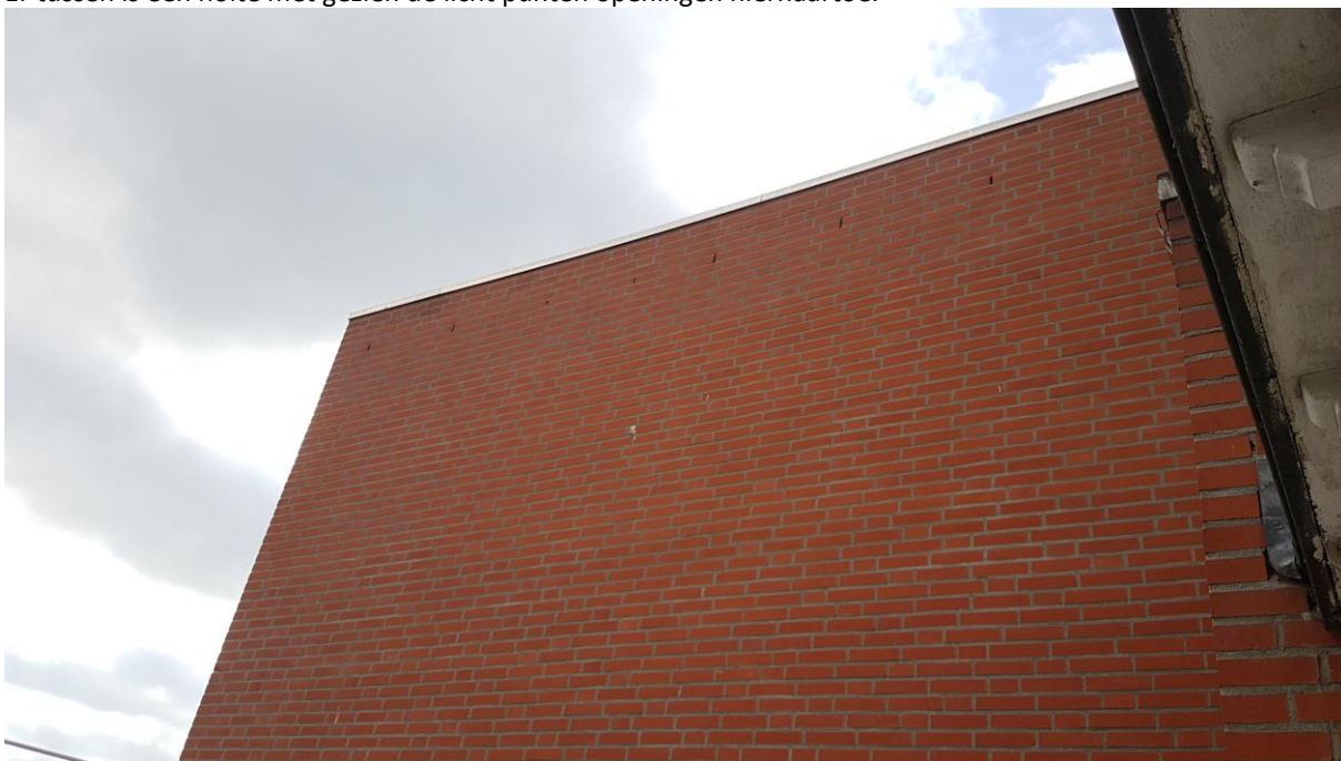
foto 19: het zuidelijke buurpand heeft open stootvoegen in de gevel die het nieuwe pand kan blokkeren.
