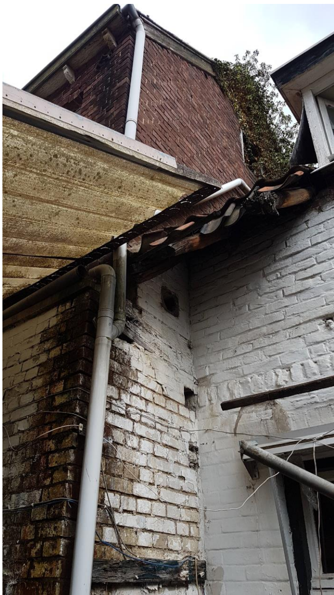
foto 21: Vele hoekjes en gaten in de verweerde gevels en daken.
