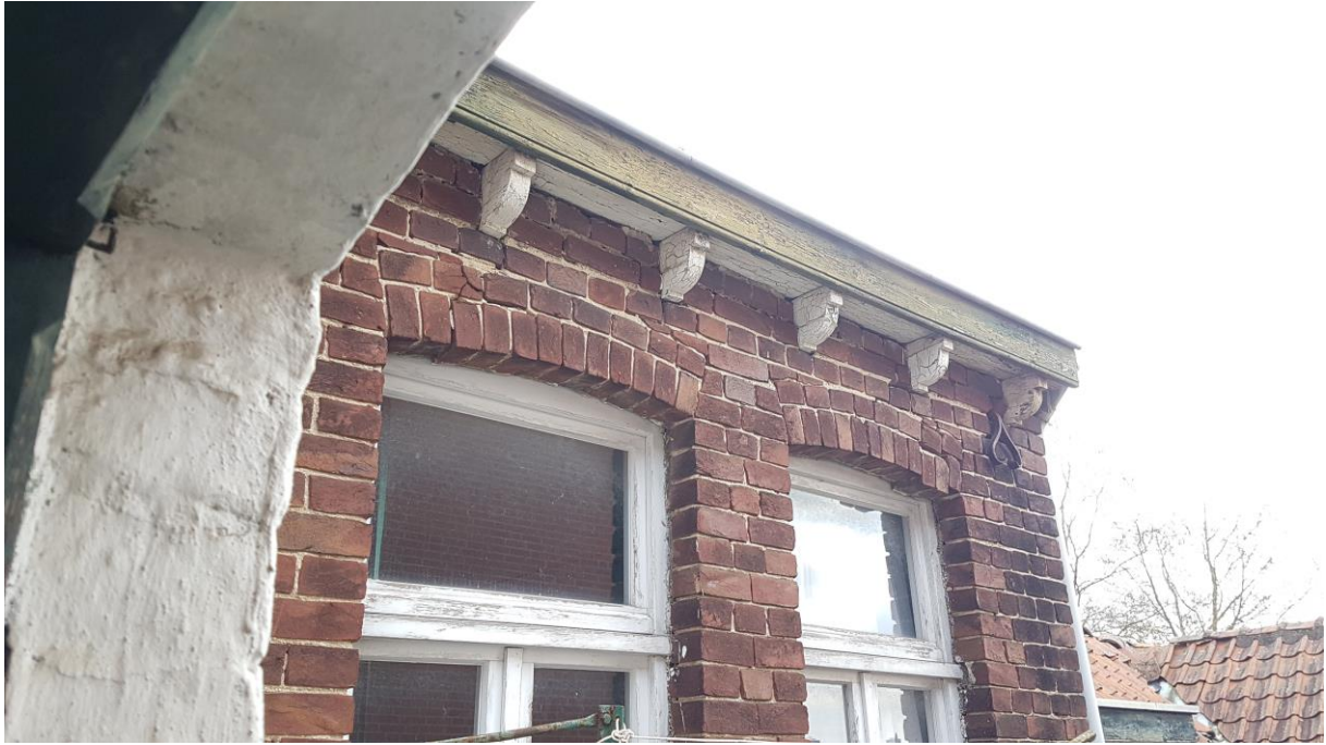
foto 19: door verwerking en slecht onderhoud zitten er vele openingen bij de dakranden.
