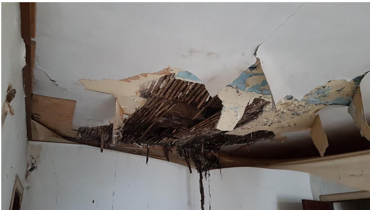
Foto 7: lekkage in het dak hebben veel schade veroorzaakt.
