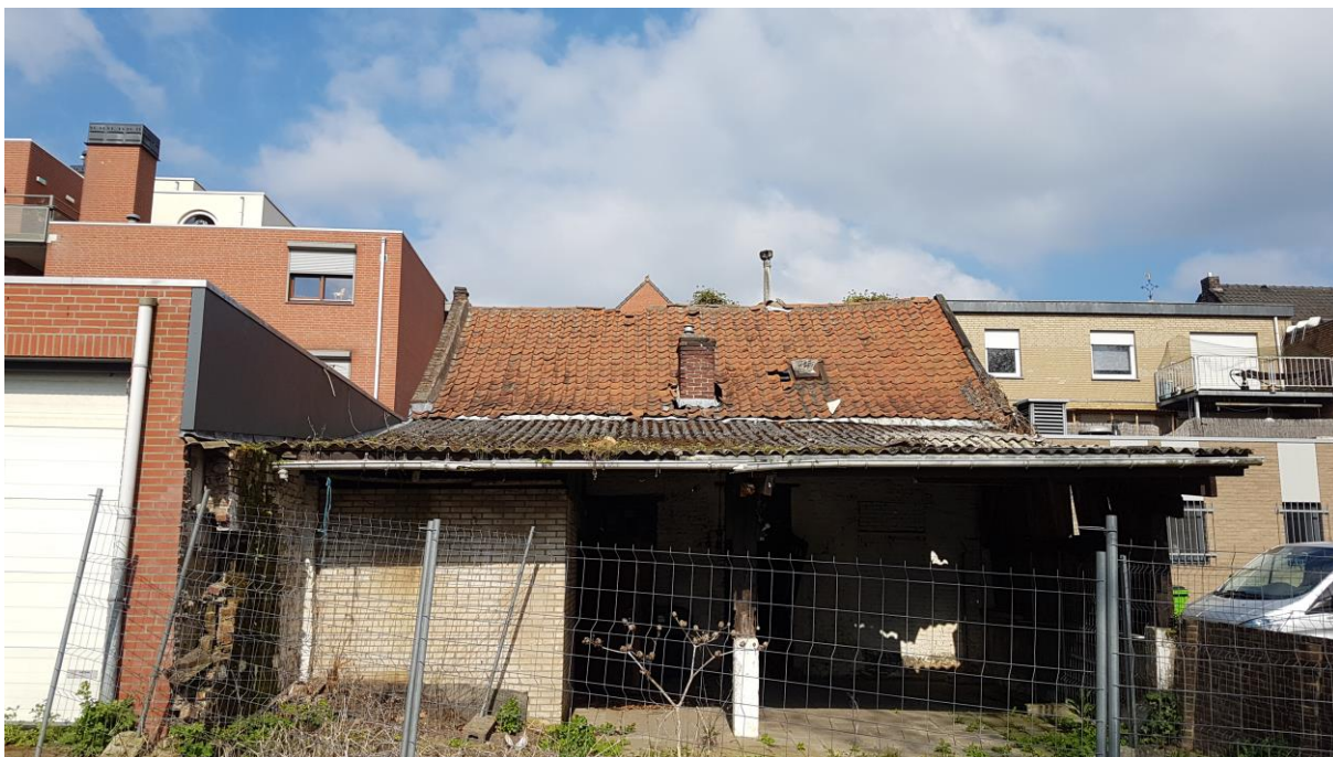
Foto 3: de overkapping met erachter de schuur. In het dak zitten meerder gaten. Links onder de overkapping het koelhok.
