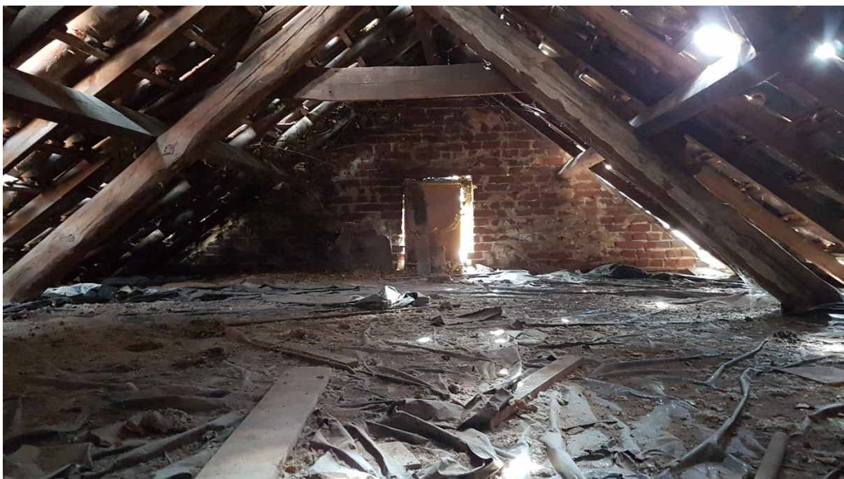
Foto 28: de zolder van het zuidelijke deel van het woonhuis. Er zijn meerdere gaten en het zijl is waarschijnlijk aangebracht om lekkages destijds te verminderen.
