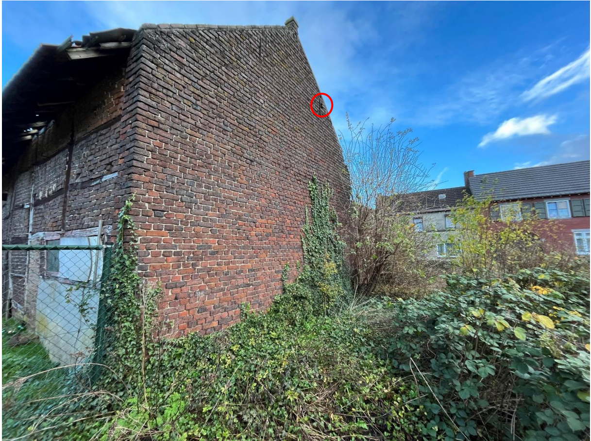
Foto 5: De gevel van de aangrenzende schuur met de missende baksteen rood gearceerd.
