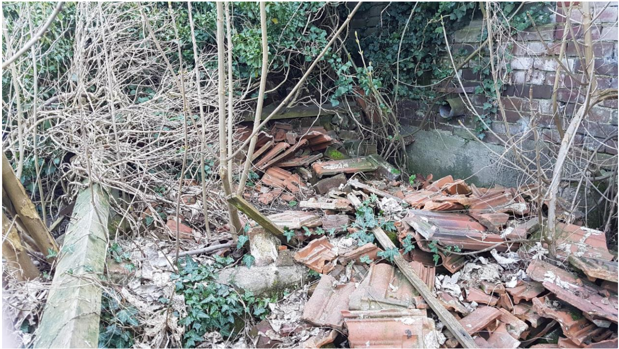
Foto 40: steenstapel ten noorden van de ingestorte hooizolder.
