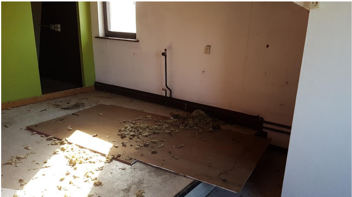
Foto 33: beschadigd isolatiemateriaal en plafondplaten op de grond .
