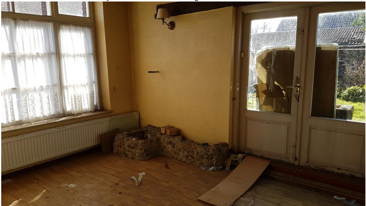
Foto 27: kapotte raam in de zijgevel van de feestzaal.
