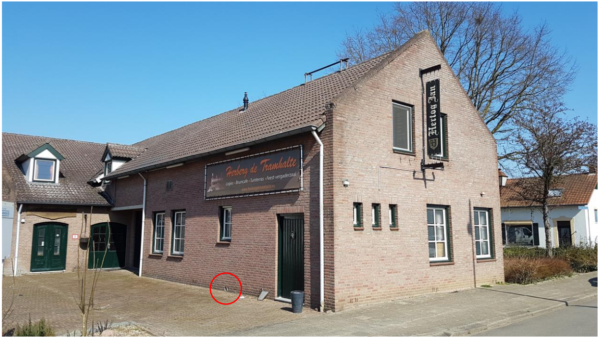
Foto 1: het hotel de Tramhalte gezien vanaf de straatzijde. Deze zijde is nog in een goede staat. De straat gevel heeft geen openstootvoegen. Bij de rode cirkel zitten de ventilatie kanalen naar de kelder.
