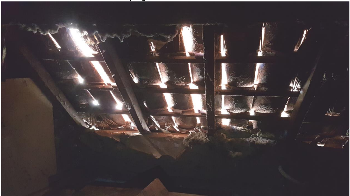
Foto 19: isolatie materiaal wat ernstig beschadigd is.
