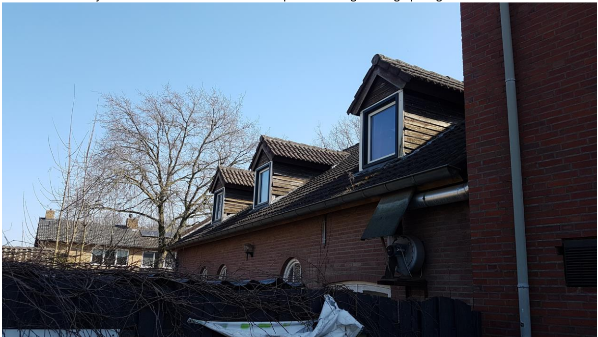
Foto 15: het boeiboord van de kleine dakkapellen aan de noordzijde zit los en er ontbreken delen. Dit biedt mogelijk verblijfplaatsen voor vleermuizen.
