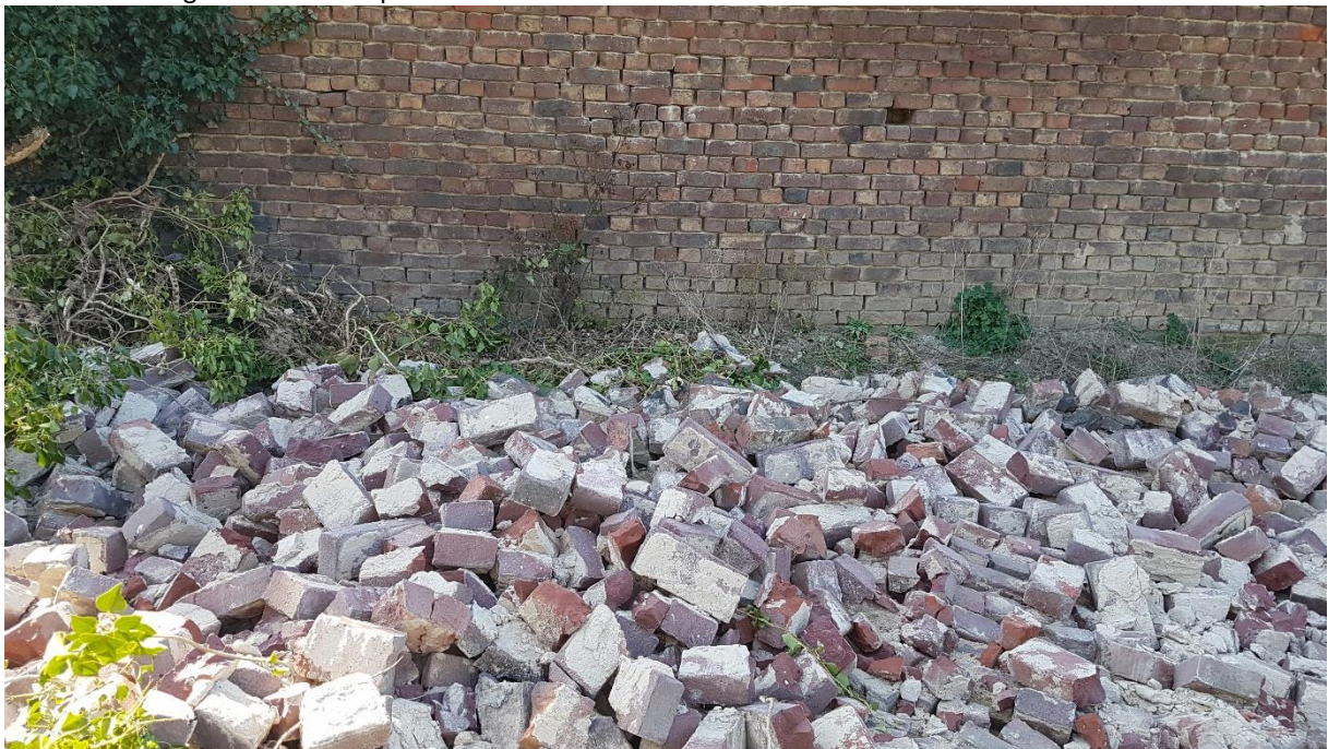
Foto 39: steenstapel bij de ingestorte hooizolder.
