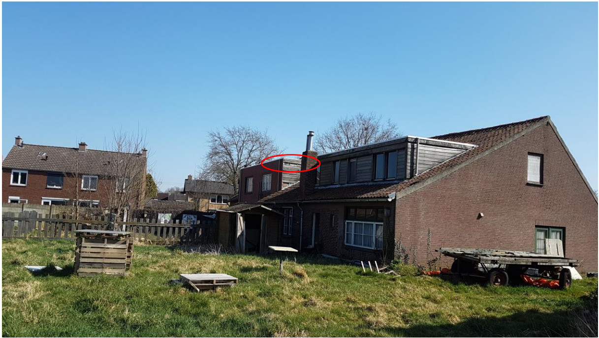
Foto 26: het boeiboord aan de zijkanten van de nieuwe aangebouwde delen is in slechte staat en ontbreekt soms.
