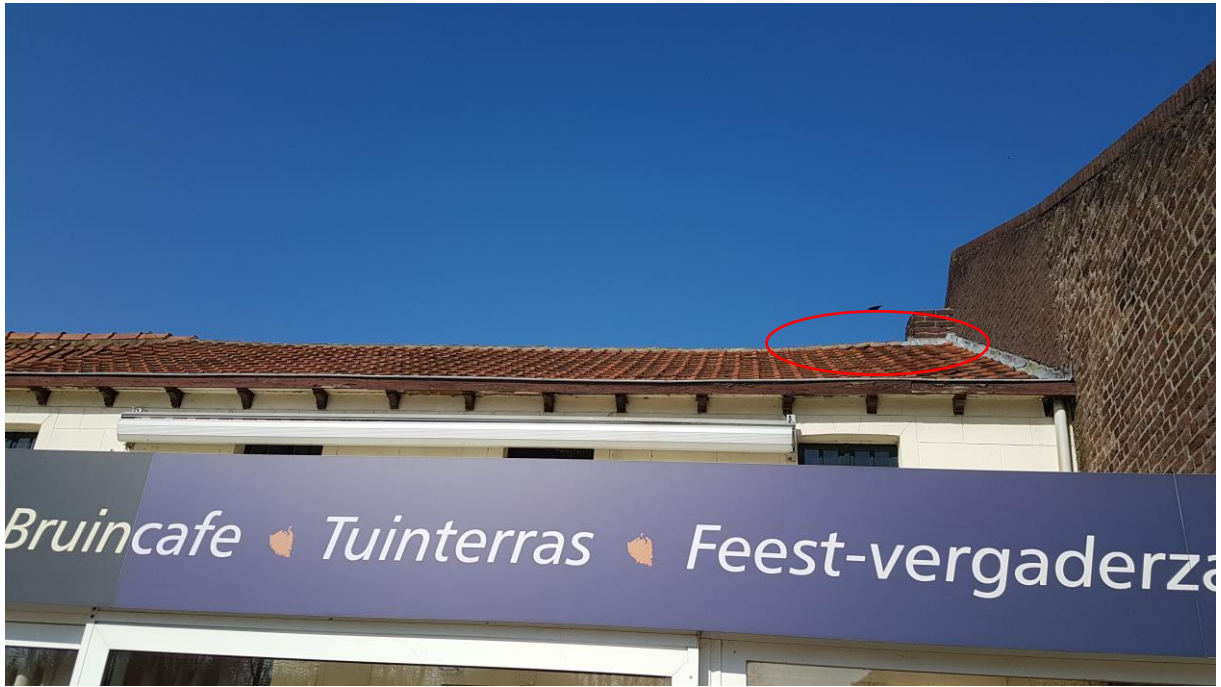
Foto 24: niet alle dakpannen sluiten netjes aan.
