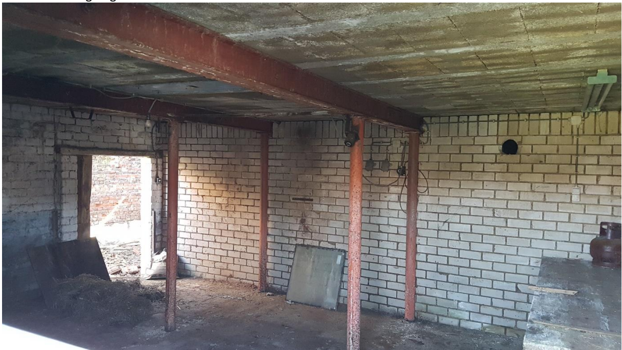
Foto 8: derde garage achter het woonhuis. Deze was ontoegankelijk door dat de hooizolder erboven was ingestort.
