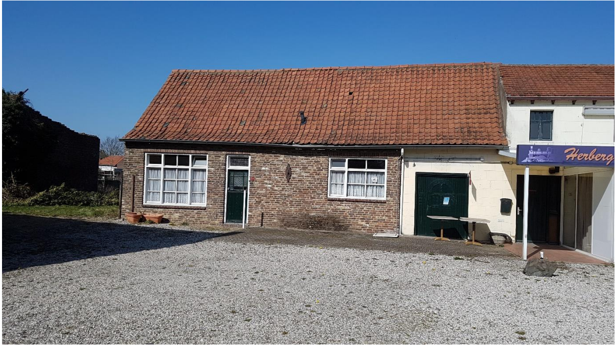
Foto 3: de feestzaal op de onderzoekslocatie. Met rechts daarvan de doorgang naar het grasveld achter de bebouwing. Goed te zien zijn de OH dakpannen en dat er enkele ontbreken.
