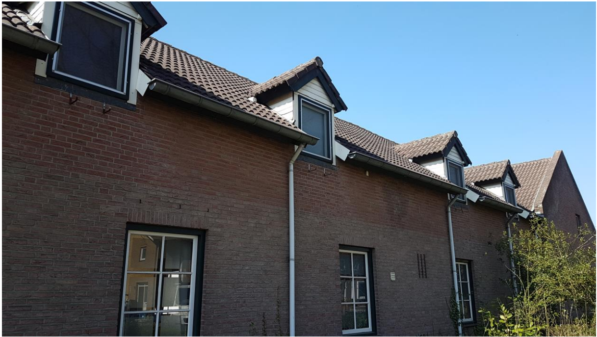
Foto 14: de oostzijde van het hotel heeft meerdere openstootvoegen hoog op de gevel.
