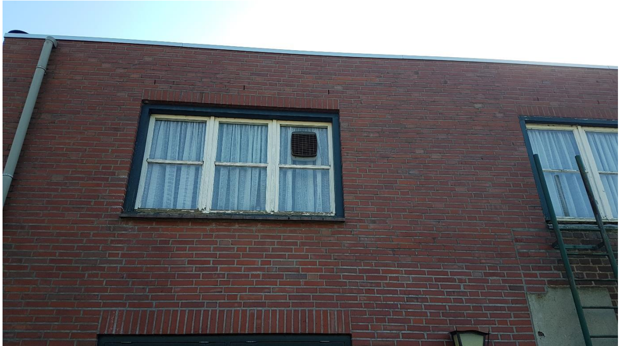
Foto 25: nieuw aangebouwde deel heeft openstootvoegen hoog op de gevel zitten.
