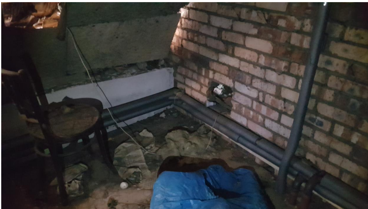
Foto 20: isolatie materiaal op de grond bij de doorgang naar het knieschot.
