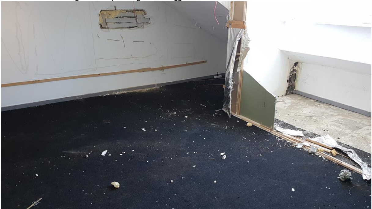
Foto 19: de schade veroorzaakt door de illegale hennep teelt.
