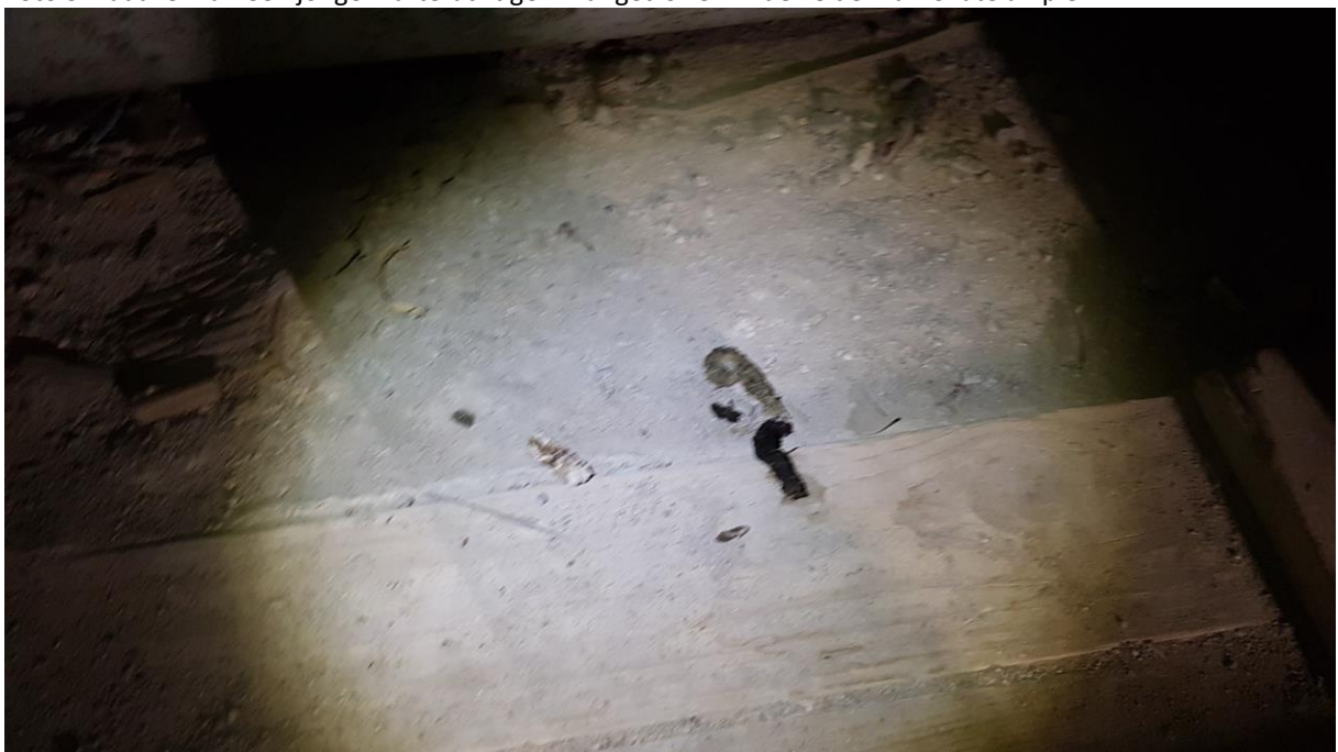
Foto 6: Fecaliën van een marterachtigen in de kruipruimte te zien vanuit de kelder in Chatelainplein 1.
