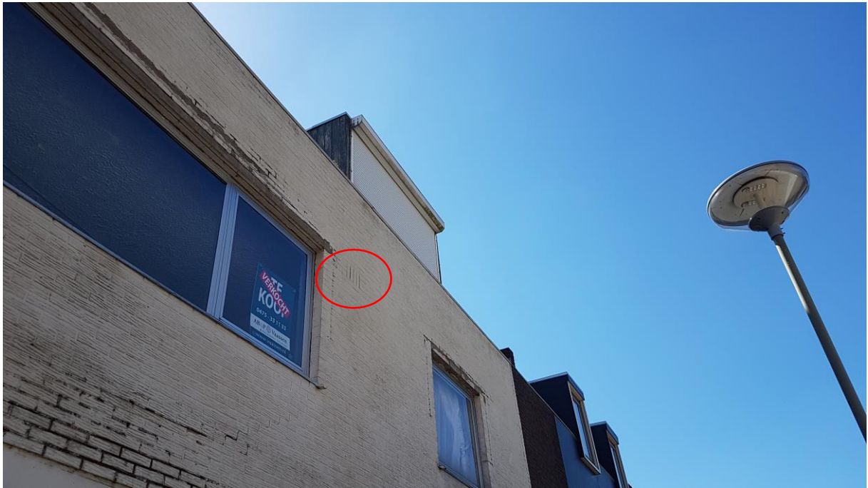
Foto 15: tegenover de stootvoegen en op ongeveer de zelfde hoogte staat een lantaarnpaal.
