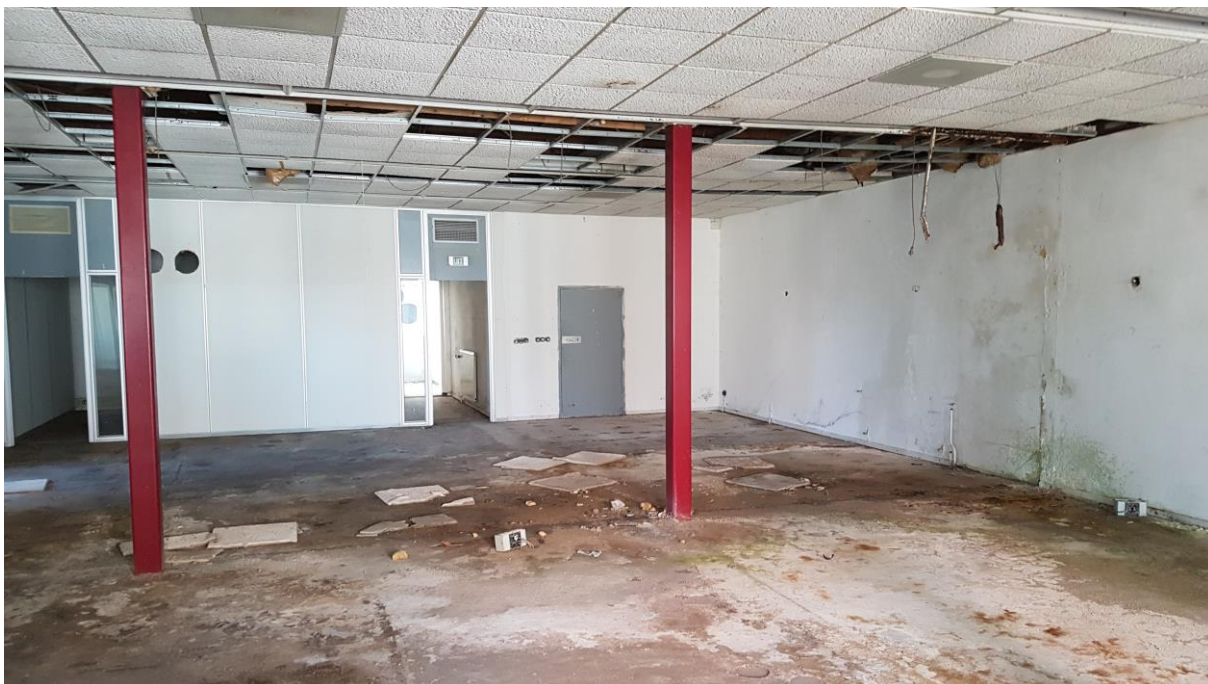
Foto 3: de begane grond van Chatelainplein 1 het bankkantoor. Er is door lekkage en illegale activiteiten veel schade.
