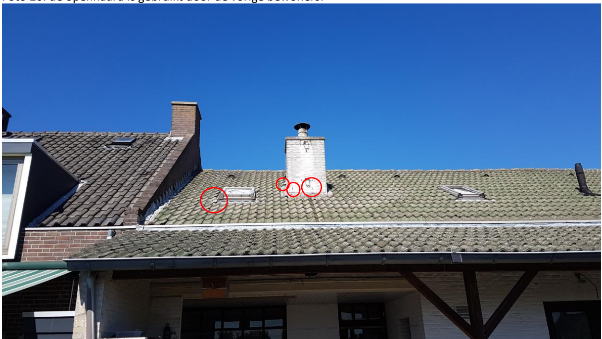
Foto 27: de openstootvoegen in de openhaard van Chatelainplein 5 welke 2 jaar terug nog in gebruik is geweest. N.B. kan je ook de omhoog gekrulde loodslabben zien.
