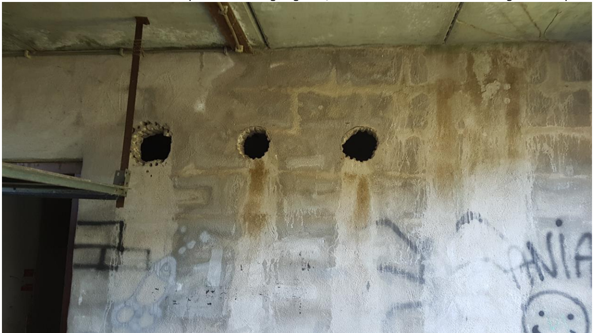
Foto 31: ventilatie gaten gemaakt door de vorige bewoners.
