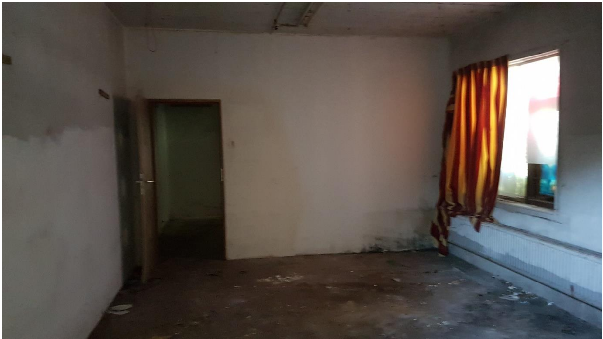
Foto 30: de aanbouw van Chatelainplein 5 naar de garage toe, ook dit was onderdeel van de illegale hennepcultuur.
