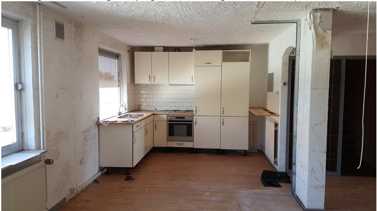
Foto 17: veel vocht en schimmel in de bovenwoning van Chatelainplein 3.
