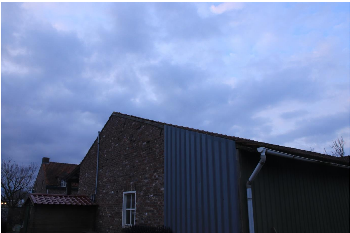
Foto 1: te slopen werkschuur/garagestalling
