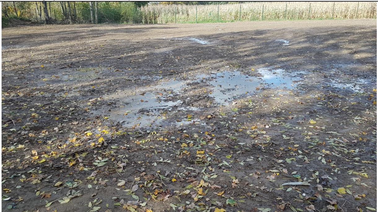
Foto 12: plas ontstaan tijdens de bouw.
