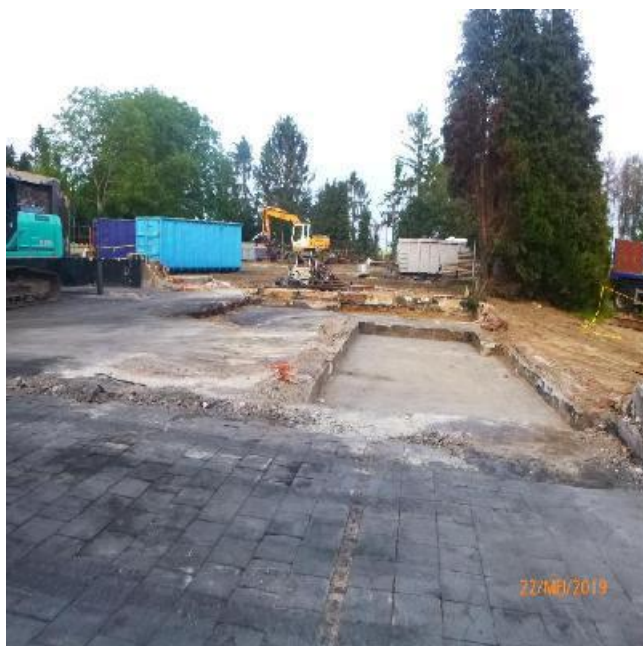
Overzicht foto compleet verwijderde gesloopte bouwdelen van de brandhaard (opslagloods en werkplaats)
