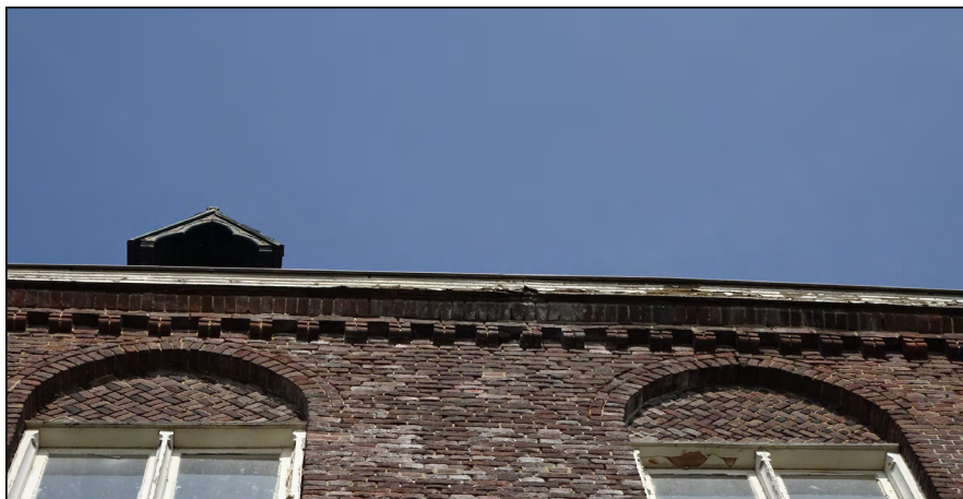
Figuur: overstek van het dak is in verval en er een ruimte tussen de overstek en de rollaag, waardoor de dakrand toegankelijk is voor vleermuizen en vogels.
