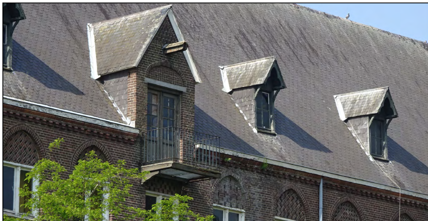
Figuur: op het dak zijn aan alle zijden in verval zijnde dakkapellen, met openingen in ramen, onder overstek en daklood, die toegankelijk zijn voor vleermuizen en vogels.
