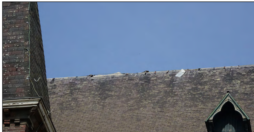
Figuur: het dak heeft op verschillende plaatsen loszittend lood en dakleien, waardoor het toegankelijk is voor vleermuizen en vogels.
