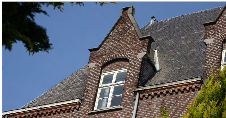
Figuur: vervallen kozijnen met op enkele plaatsen kapotte ruiten en verrotte kozijnen, waardoor toegankelijk voor vleermuizen en vogels. Op de begane grond zijn de kozijnen toegankelijk voor steenmarter.
