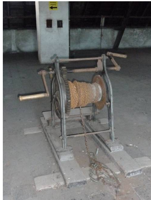
87 hijsinstallatie in ruimte 3.18
