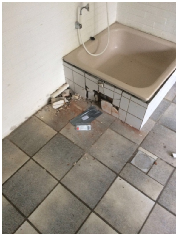
3. M.02 Teerlaag onder tegelvloer
