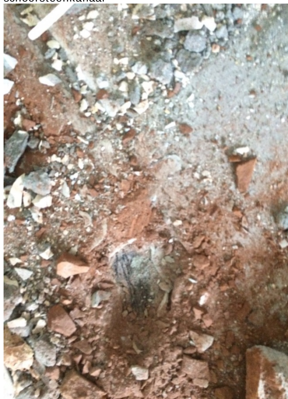
4. M.02 Teerlaag onder tegelvloer
