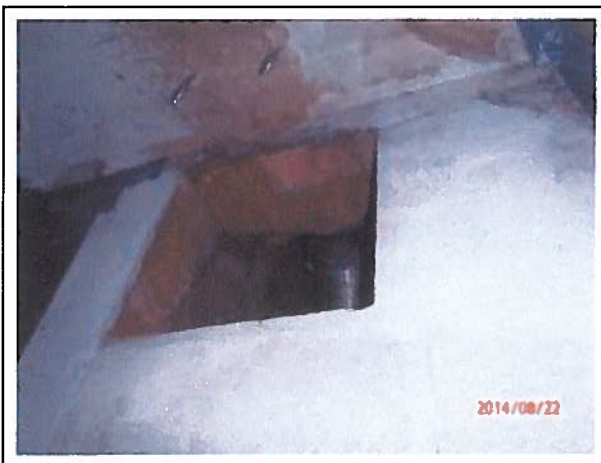
Foto 4: Plaats van de verwijderder plaat
