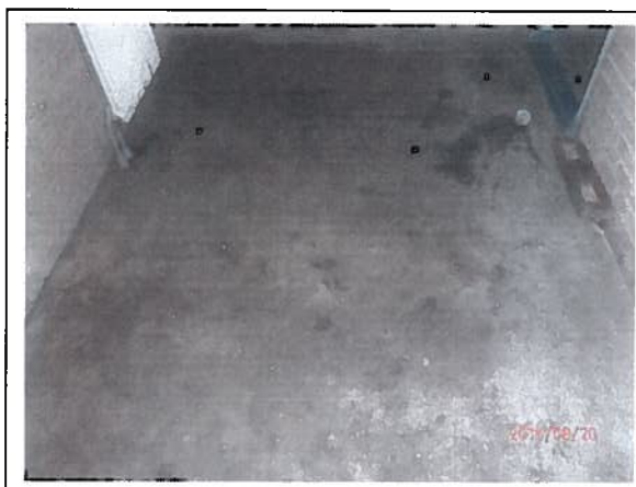
Foto 6: Verwijderde besmetting op de vloer van het voorportaal van de CV-ruimte
