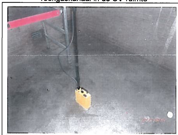
Foto 10: Opstelling pomp 2 in de CV-ruimte
