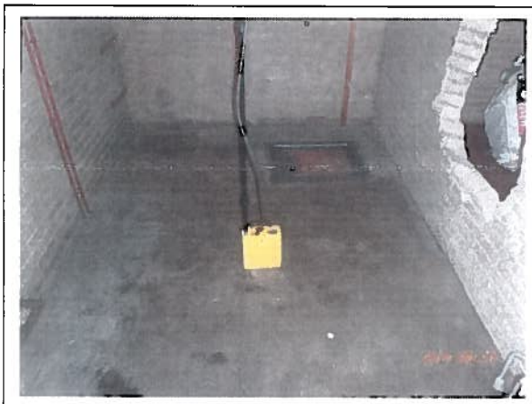
Foto 9: Opstelling pomp 1 in het portaal
