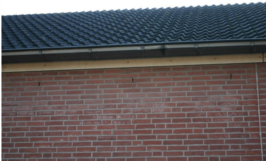
Figuur 4.4.3. In de loods zijn op diverse plekken open stootvoegen op ca. 4 meter hoogte aanwezig, waardoor vleermuizen de spouw kunnen bereiken.
