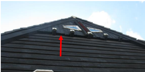
Foto 15: Schuur aan de Schansweg te Klundert met openingen onder de daklijst en gevel betimmering.
