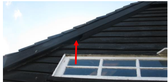
Foto 16: Opening onder de daklijst.
