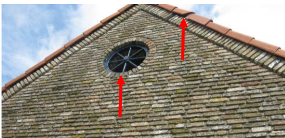
Foto 17: Open raam in schuur aan de Zuiddijk 45 en ruimte onder dakpannen.
