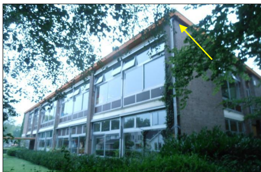
Figuur 13. Invliegplaats onder dakrand.
