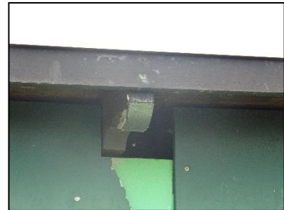
Figuur 17. Detail van de derde opstal, rondom de steunbalken zijn openingen aanwezig.
