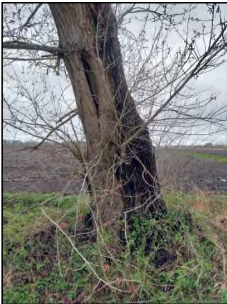
Figuur 22. Eén van de twee holtes in de boom gelegen aan de noordrand van de onderzoekslocatie.
