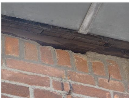
Foto 46: Pand 5 – kieren en openingen bij dakrand westzijde.
