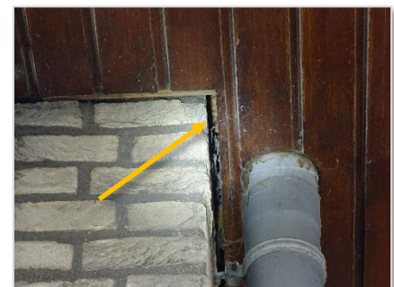
Foto 27: Pand 4 – kieren langs dakaansluiting gevel.
