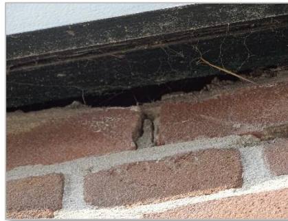
Foto 23: Pand 3 – huisje weegbrug openingen bij dakrand.
