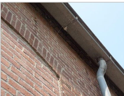
Foto 47: Pand 5 – kieren en openingen bij dakrand oostzijde.
