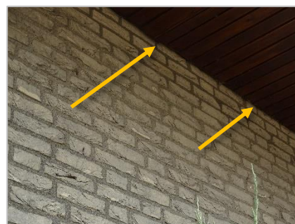
Foto 29: Pand 4 – kieren langs dakaansluiting gevel.
