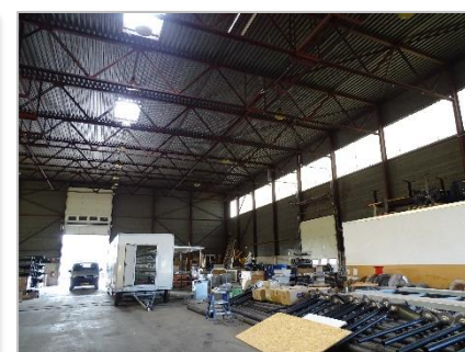
Foto 18: Pand 2 – interieur (opslag materialen).
