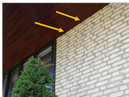
Foto 28: Pand 4 – kieren langs dakaansluiting gevel.
