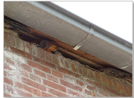
Foto 48: Pand 5 – kieren en openingen bij dakrand oostzijde.
