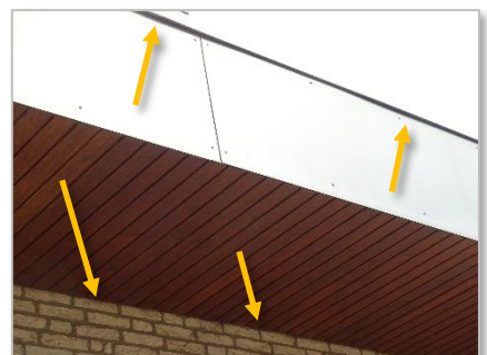
Foto 30: Pand 4 – kieren langs dakaansluiting gevel en dakrand.
