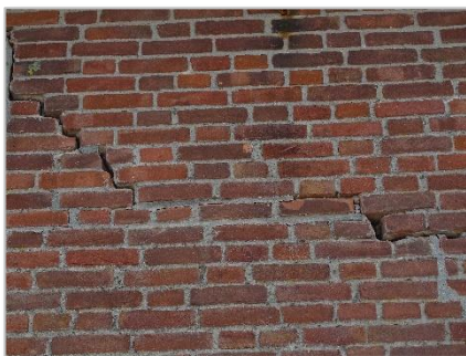
Foto 22: Pand 3 – huisje weegbrug scheuren in gevel.
