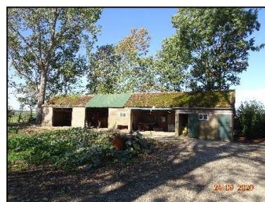
Figuur 8. De kleine opstal met golfplaten dak. Het groene golfplaten dak is van asbest.
