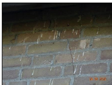
Figuur 16. Poepspoor op de buitenmuur onder de dakgoot van het woonhuis.
