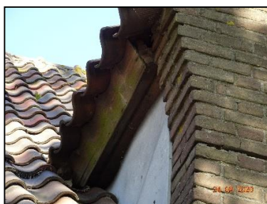
Figuur 21. Detailfoto van de dakkapel van de grote opstal. De dakkapel sluit niet volledig aan op de dakpannen waardoor ruimte tussen de dakpannen en het dak open blijft.
