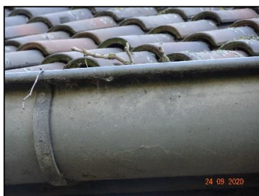
Figuur 15. Detailfoto van de dakgoot van het woonhuis. Zichtbaar zijn takjes die boven de dakgoot uitsteken.
