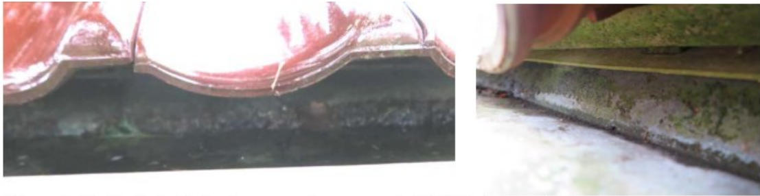
Figuur 2. Dicht dak in de te slopen woningen aan de G.W. Stoïnkweg 110A Zuidveen.
