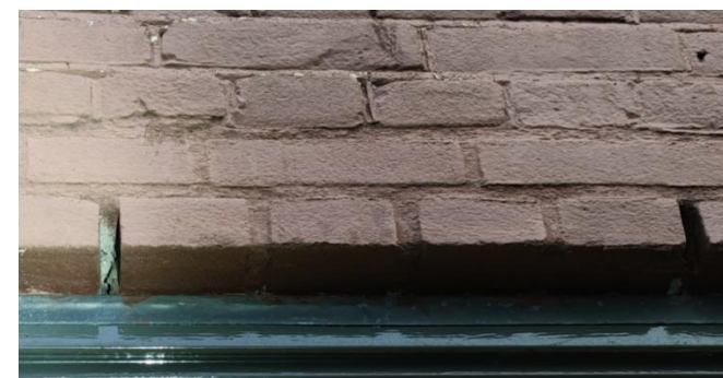
Figuur 15: Open stootvoegen boven raamkozijn in westgevel van de Jumbo
