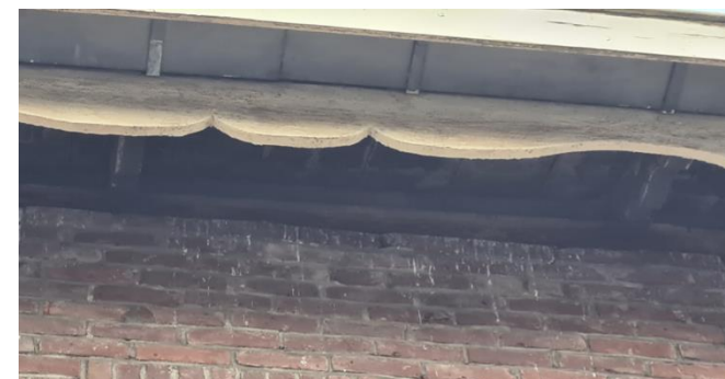
Figuur 12: Dakrand van het gebouw aan de Tukseweg 13
