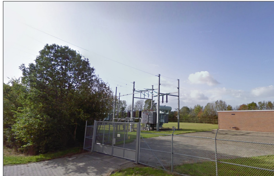
Afbeelding 11. Heesterrand (aan de westkant) waar de lijnen van het transformatorstation naar de mast lopen
