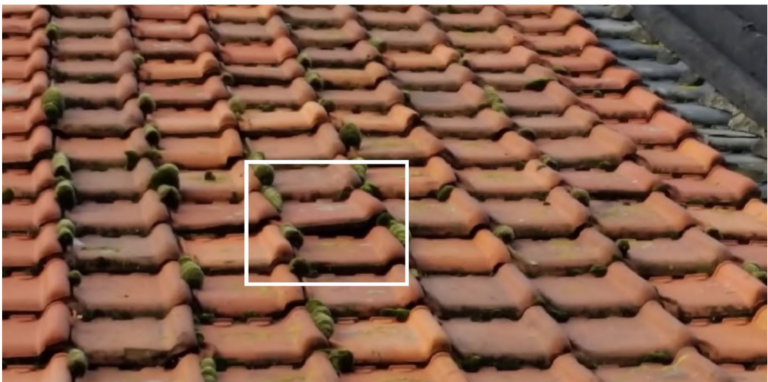
Openingen in het pannendak van het woonhuis
