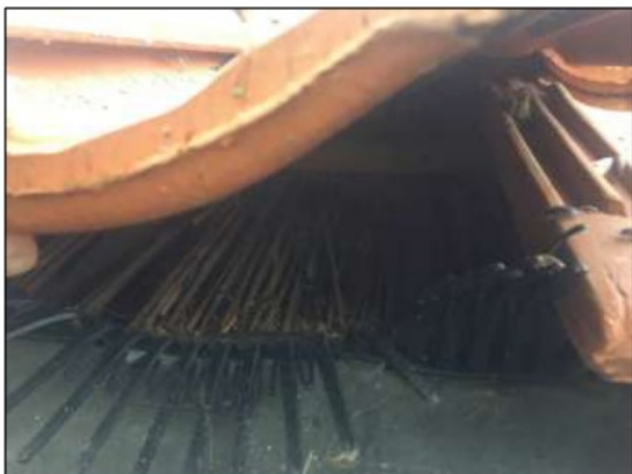
Vogelschroot onder de dakpannen voortkomt dat huismussen onder de dakpannen kunnen nestelen.
